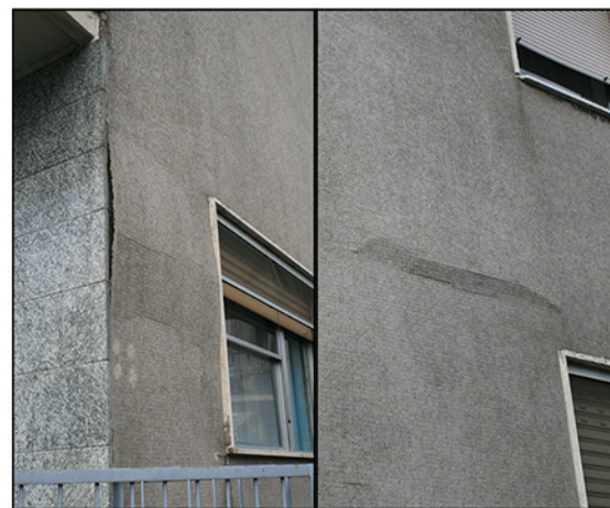
Fig. 76-77 - foto del degrado dell'intonaco esterno
