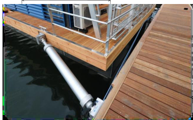
F2.56: Foto e dettagli del sistema d'ormeggio dei moduli galleggianti
