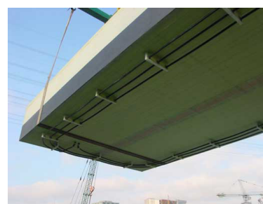
F3.53: Serpentina di tubi per lo scambio termico con l'acqua del mare
