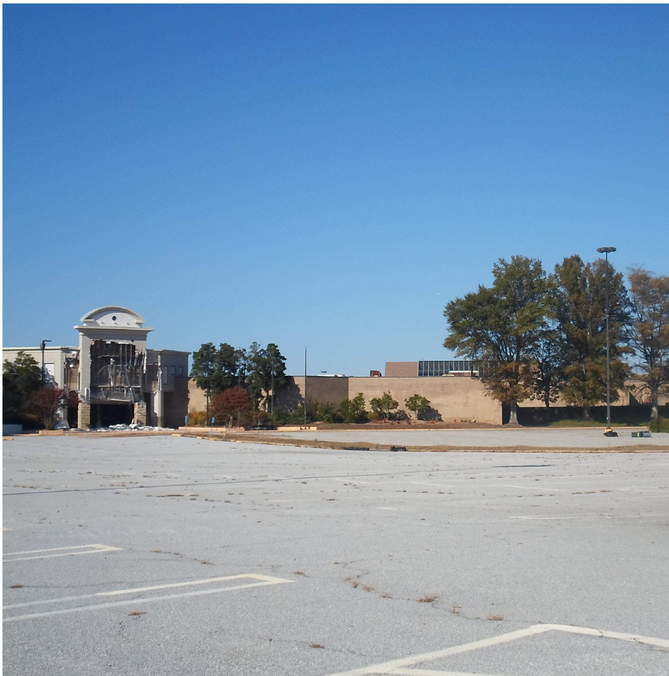
Fig. 381 -Shannon Mall dopo la cerimonia di inizio demolizione, ottobre 2014 Fig. 381-Shannon Mall after the ceremony to mark the start of demolition, October 2014
