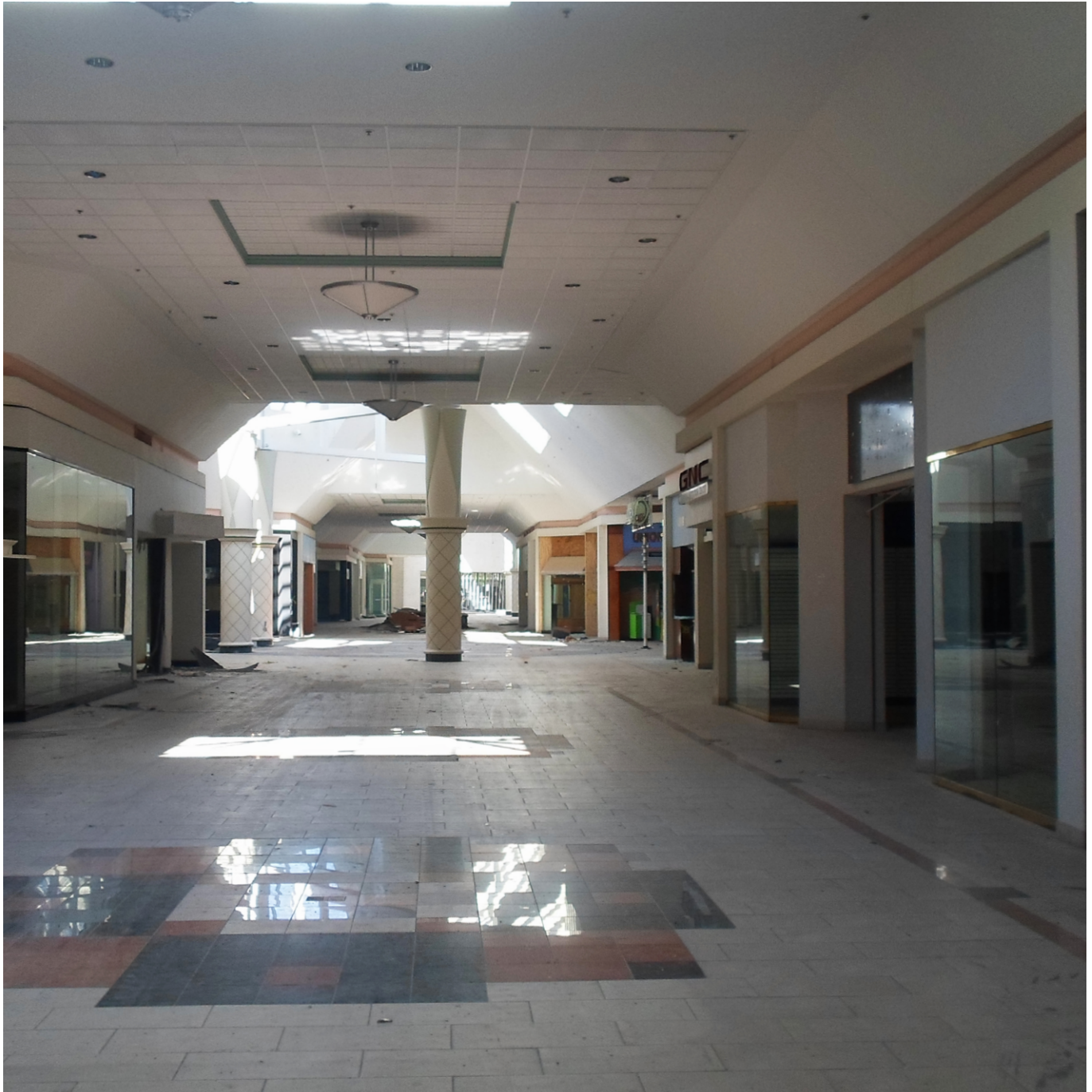
Fig. 382 -Interno di Shannon Mall durante la demolizione, ottobre 2014 Fig. 382-Internal space of Shannon Mall during demolition, October 2014
