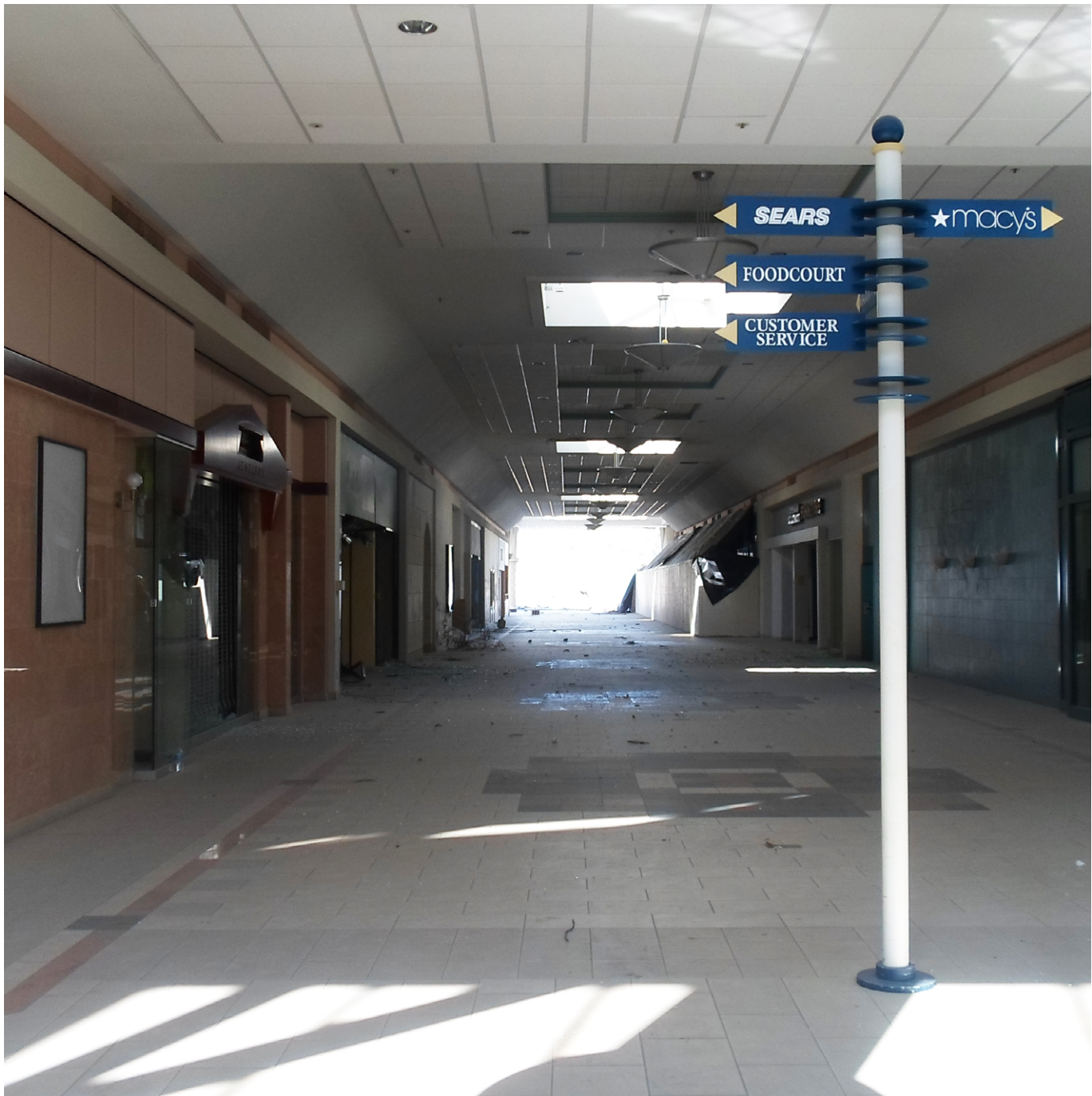
Fig. 383-Interno di Shannon Mall durante la demolizione, ottobre 2014 Fig. 383-Internal space of Shannon Mall during demolition, October 2014
