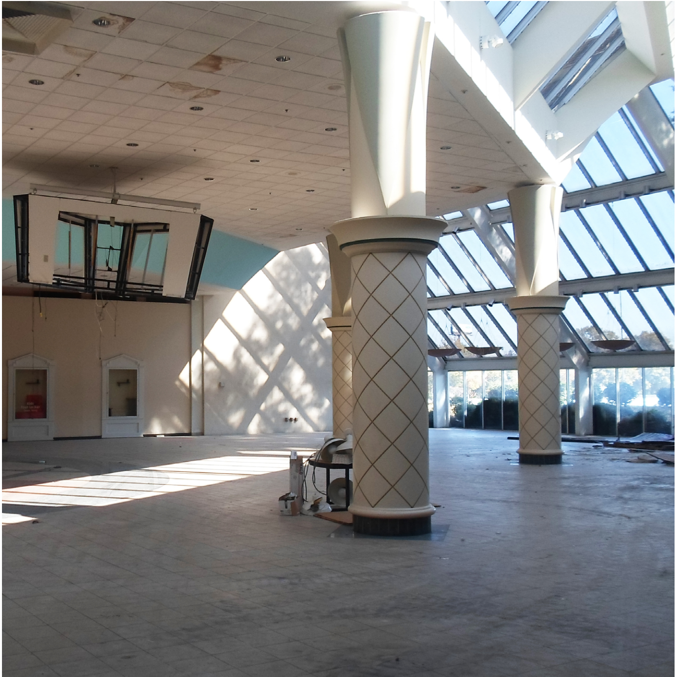
Fig. 384 -Interno di Shannon Mall durante la demolizione, ottobre 2014 Fig. 384-Internal space of Shannon Mall during demolition, October 2014
