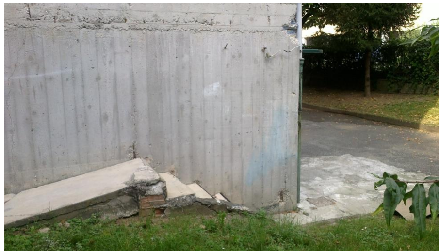
Figura 3.18, Dissesto scale fronte sud-est e vista del distacco di cemento armato.
