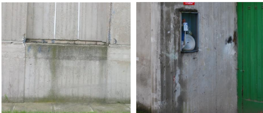
Figura 3.16, Presenza di patina biologica e macchie scure in prossimità dell'attacco a terra.
