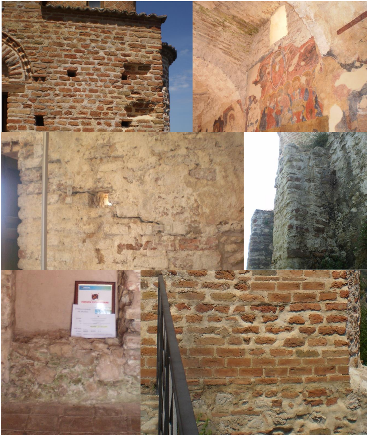
Figura 3.27 – Esempi di degrado riscontrabili, in ordine: mancanza sul lato destro della parete Sud, patina biologica sulla volta a botte del lato Est, fratturazioni e fessurazioni sulla parete Sud, deposito e presenza di vegetazione sui contrafforti ad Ovest, alterazione cromatica sulla parete Nord e sulla parete Sud.
