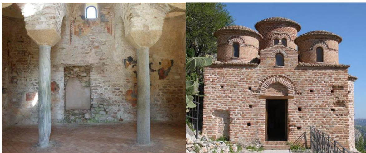
Figura 3.17 – Dettagli delle aperture tamponate sul prospetto interno a nord e sul prospetto esterno a sud.
