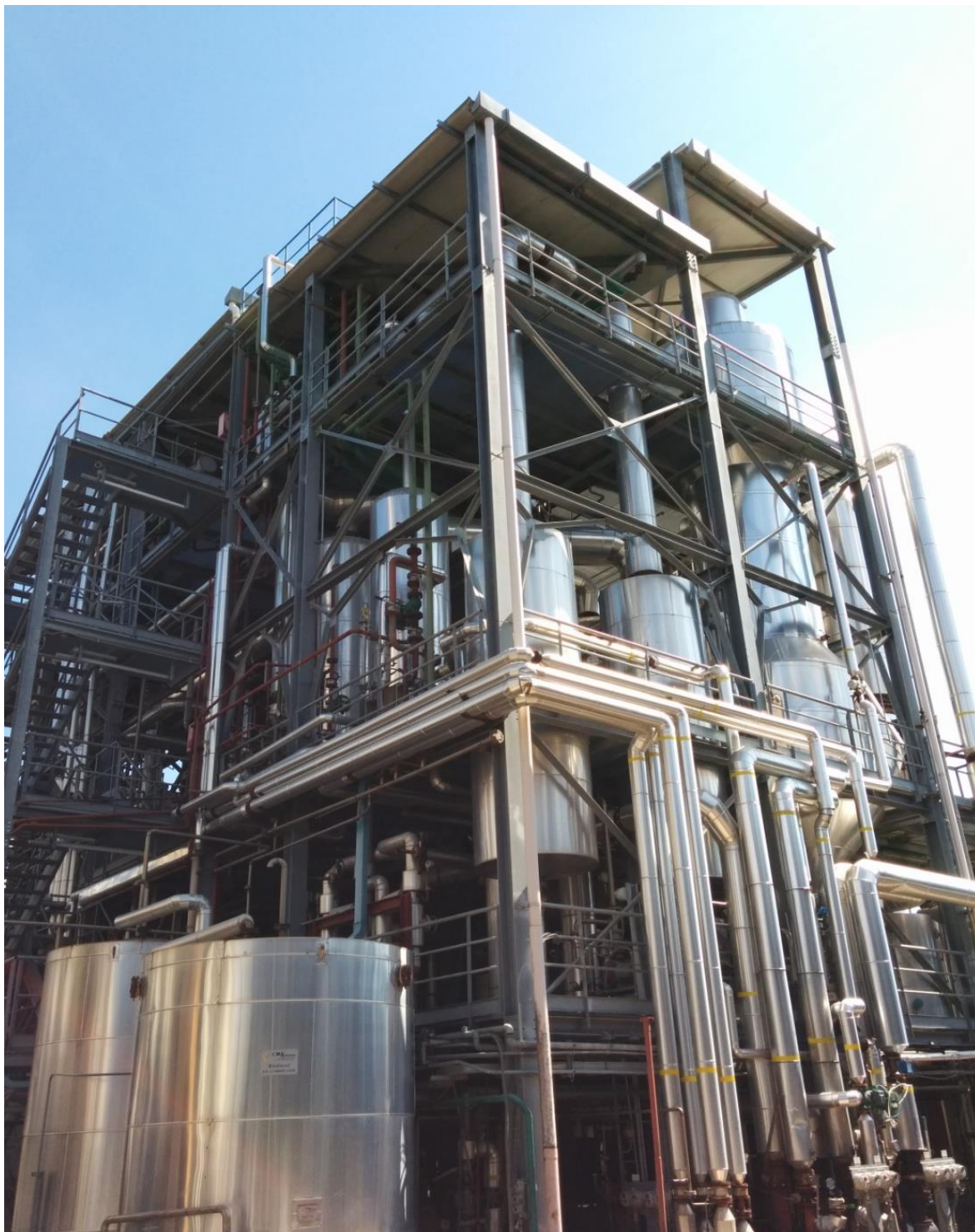
Figura 11: Parte d'impianto della DP Lubrificanti
