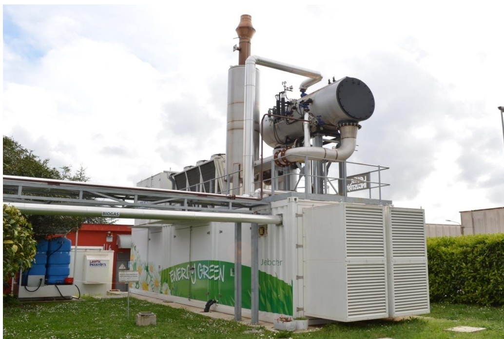
Figura 27: Motore a combustione interna cogenerativo alimentato a biogas della DP
