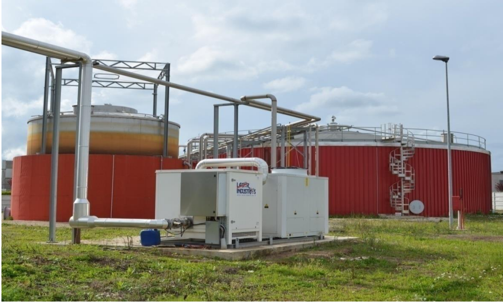
Figura 26: Digestore e gasometro DPL
