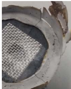
Figura 2.20: Dettaglio delle crepe
