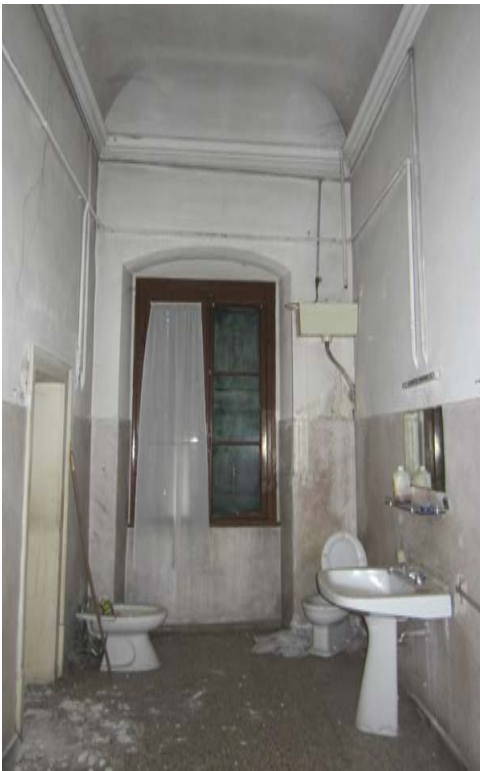
Fig.63 - Lato Sud del vano. Il locale si presenta lungo e molto stretto con sanitari posizionati in modo disordinato e non funzionale.
