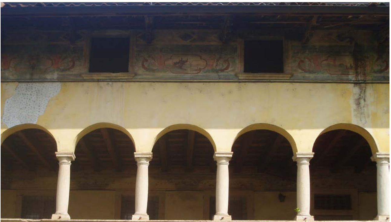
Fig. 113 - Particolare del prospetto della loggia. Di grande interesse risulta il fregio decorato che delimita l'ultimo piano dell'edificio.
