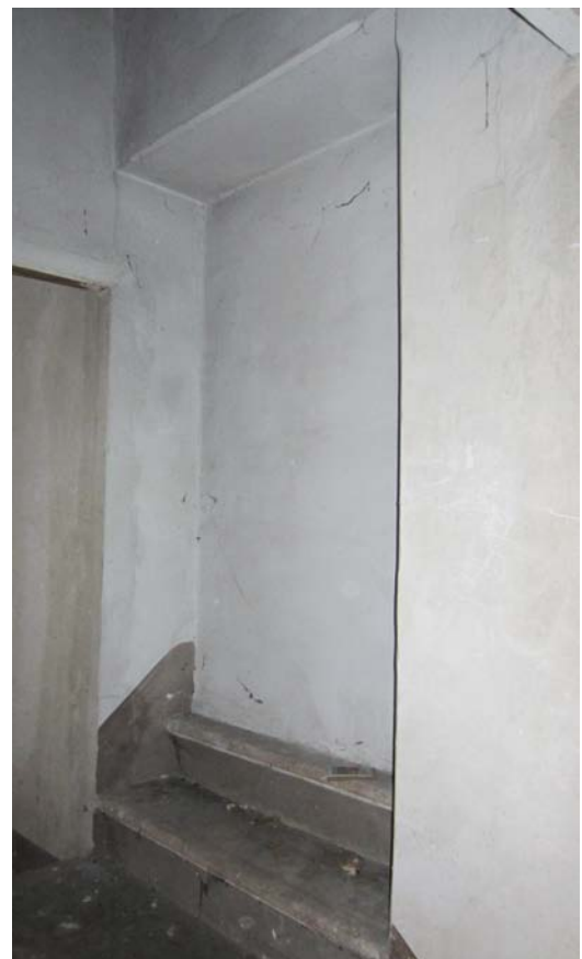
Fig.54 - Dettaglio del passaggio murato che consentiva il collegamento con l'appartamento posto sul lato Nord.
