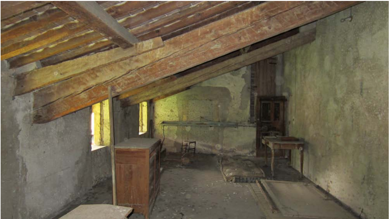
Fig.94 - Vista verso Ovest. Sulla parete in fondo al vano si nota una porta murata e un'altra apertura a destra tamponata che conserva però l'anta in legno, forse vecchio collegamento con l'ala Ovest ottocentesca.
