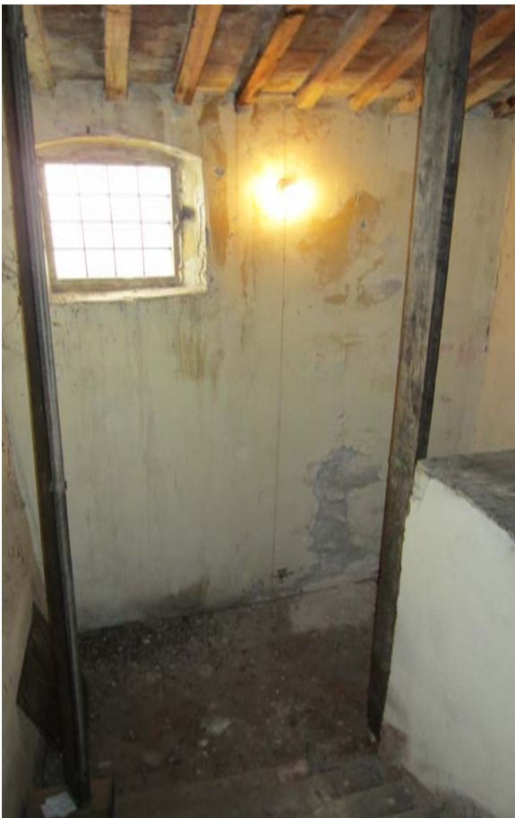
Fig.89 - Vista Nord del pianerottolo intermedio del vano scala. Sono evidenti le tracce di degrado e infiltrazioni di umidità.
