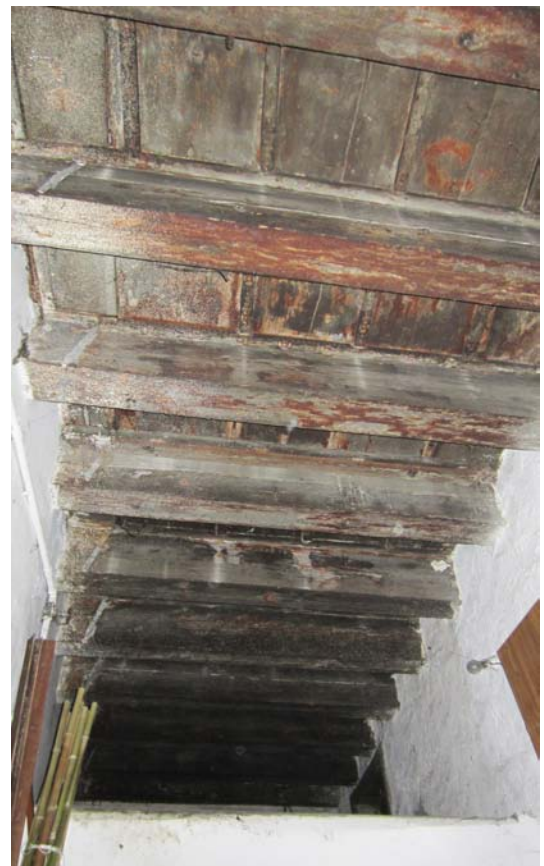
Fig.29 - Vista del solaio in legno del locale serbatoio, probabilmente risalente alla costruzione originaria.
