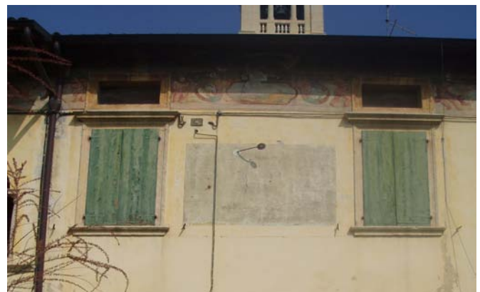
Fig.112 - Particolare della meridiana, irrimediabilmente danneggiata, presente sul prospetto Sud ottocentesco della villa.
