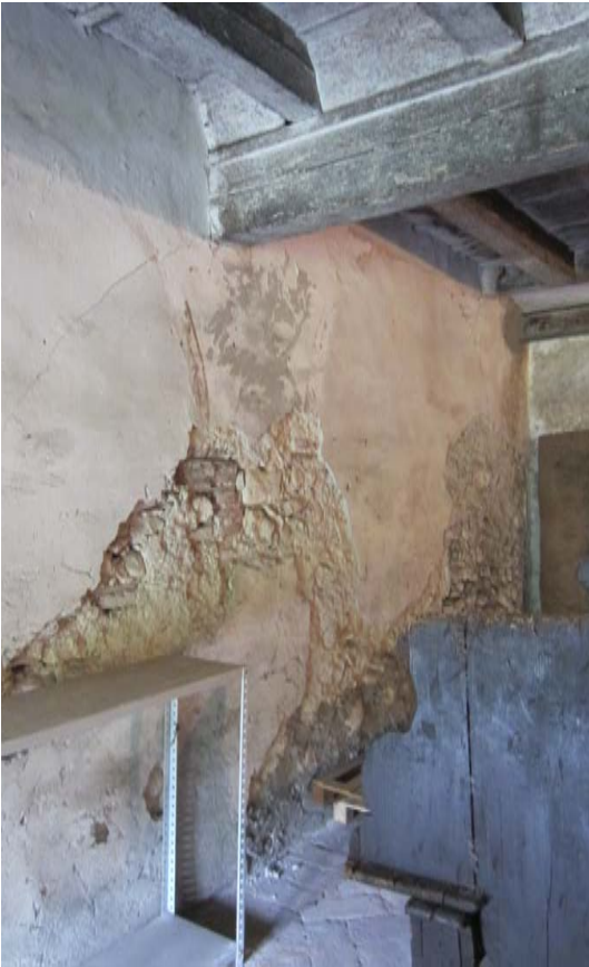
Fig.36 - Dettaglio parete Ovest del locale; segni evidenti delle decorazioni parietali. Dove mancano strati di intonaco erano probabilmente presenti altre decorazioni a rappresentare i capitelli delle finte arcate del loggiato.
