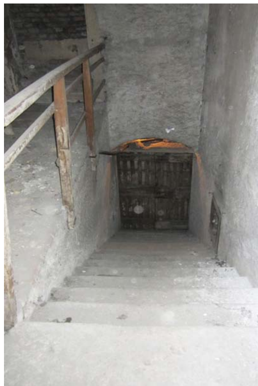
Fig.41 - Vista verso la rampa di scale per mezzo della quale era garantito l'accesso ai locali cantine.
