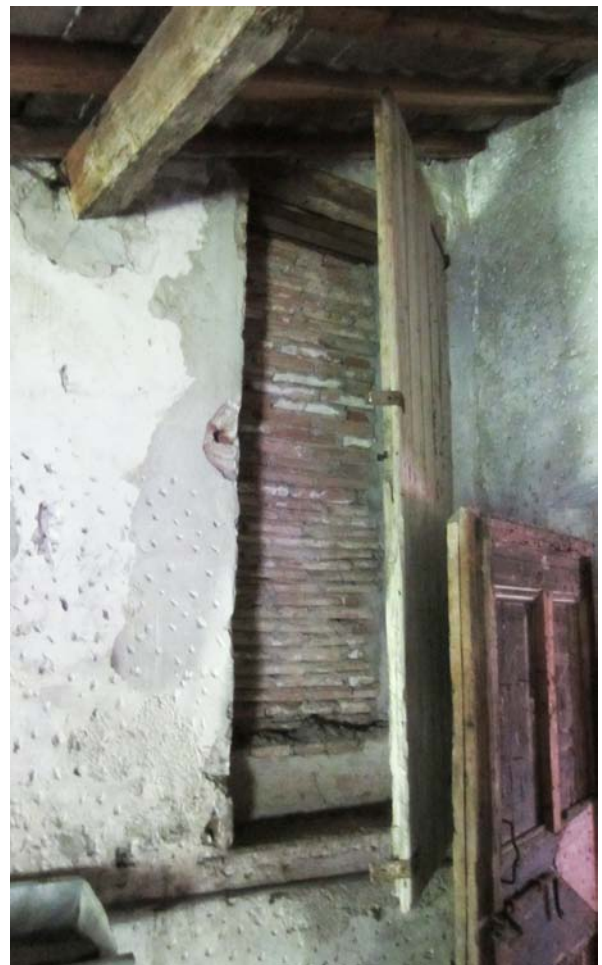
Fig.97 - Parete Ovest con la finestra murata, segno del vecchio perimetro del nucleo antico della villa.
