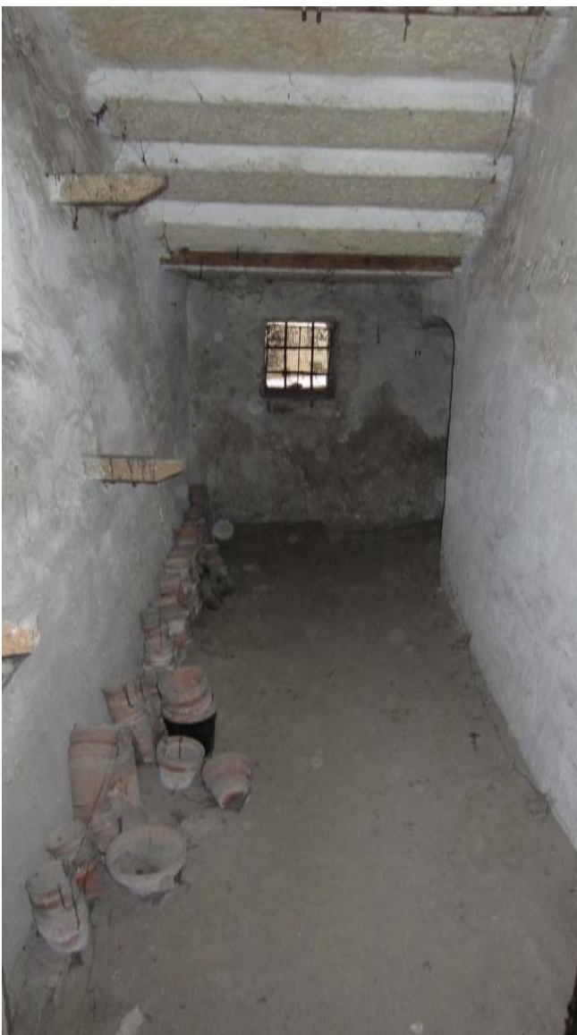
Fig. 48 - Sottoscala visto da Sud verso Nord. La finestrella si affaccia direttamente sul vicolo che separa la villa dalla chiesa di S. Martino e si trova a livello di calpestio.
