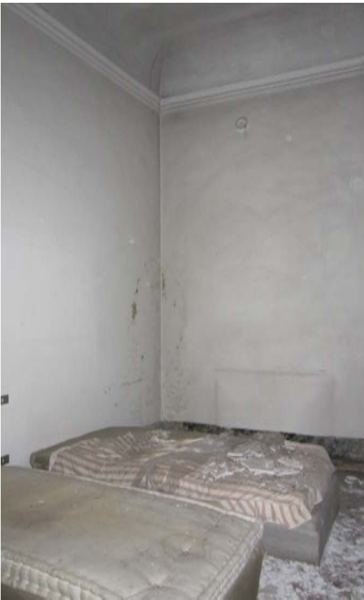
Fig.64 - Angolo Sud-Est del locale adibito a camera da letto. Il vano si presenta spoglio, fatta eccezione per i due materassi, e presenta dei cedimenti a livello del solaio.
