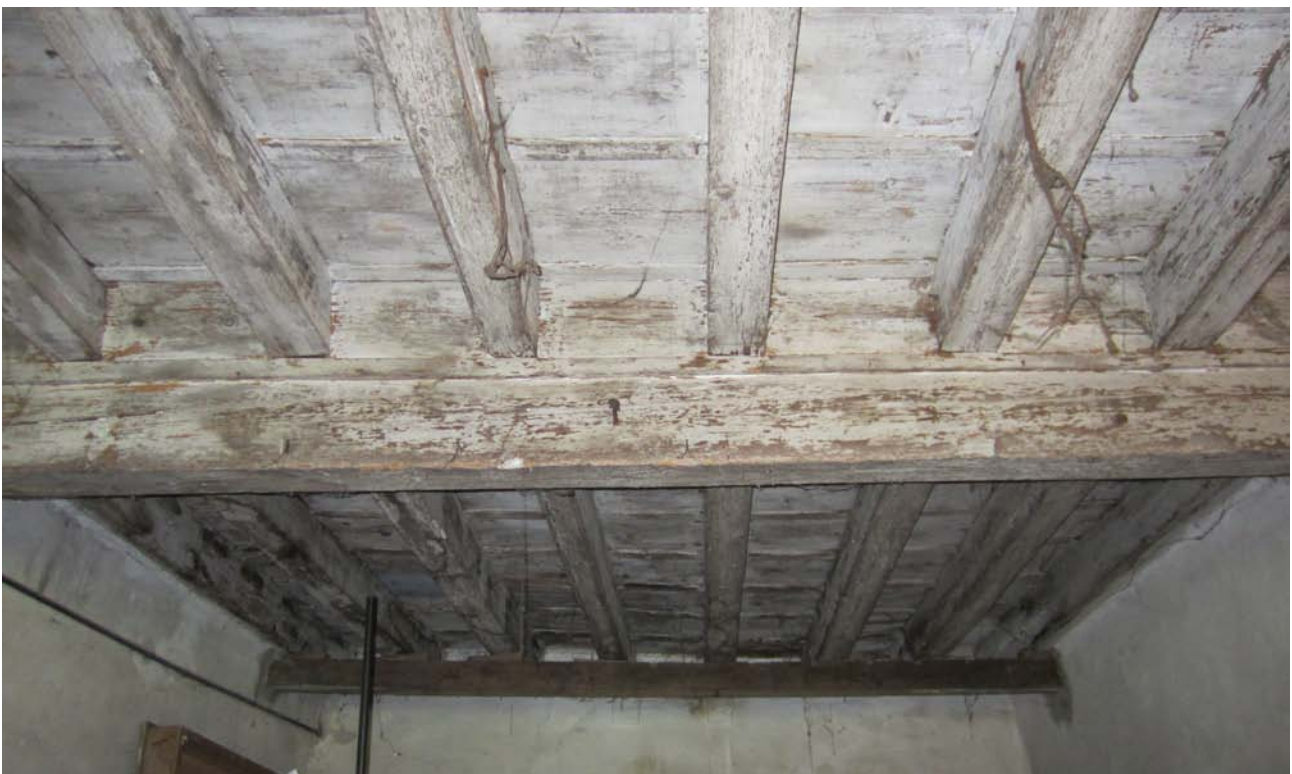
Fig. 45 - Solaio ligneo di antica fattura, probabilmente risalente al XV secolo, costituito da una doppia orditura.
