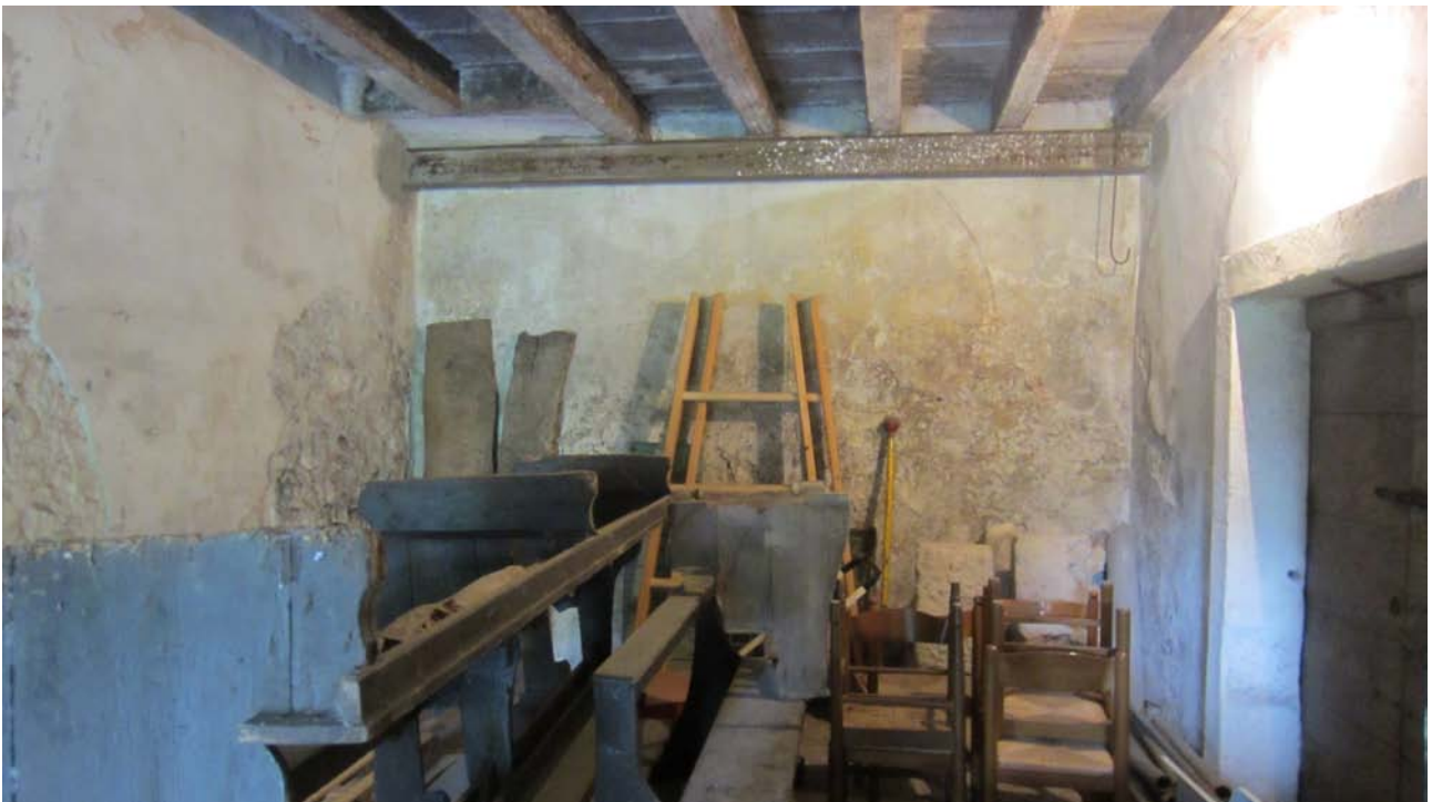
Fig. 35 - Vista della parete Nord del vano. Si possono intravedere i segni di quelle che erano delle decorazioni raffiguranti delle arcate. A destra troviamo il portone dal quale si scende ai locali delle cantine.
