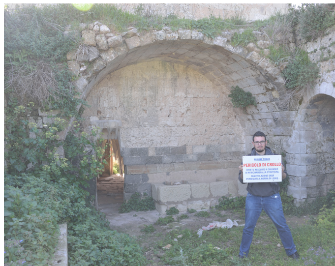
74. Vista del crollo a est della Torre
