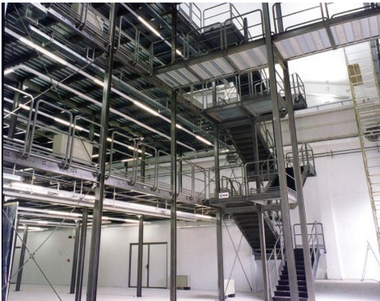
Fig 4.3.8 Vista del passaggio in quota, al secondo e al terzo piano, di collegamento con la scala di sicurezza collocata sulla facciata principale di via Palermo. _ Archivio Ufficio Tecnico – Università degli Studi di Parma
