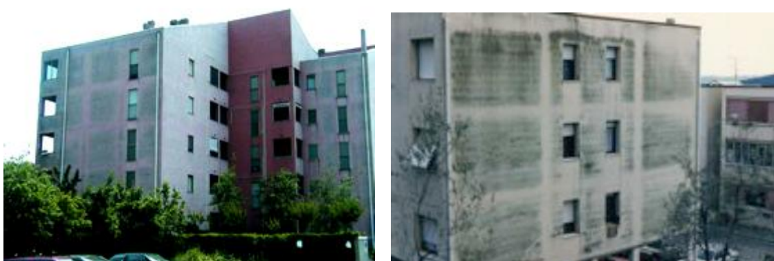
Figura 10 - Alterazione cromatica differenziata tra muratura di tamponamento e struttura portante (www.waler.it)
