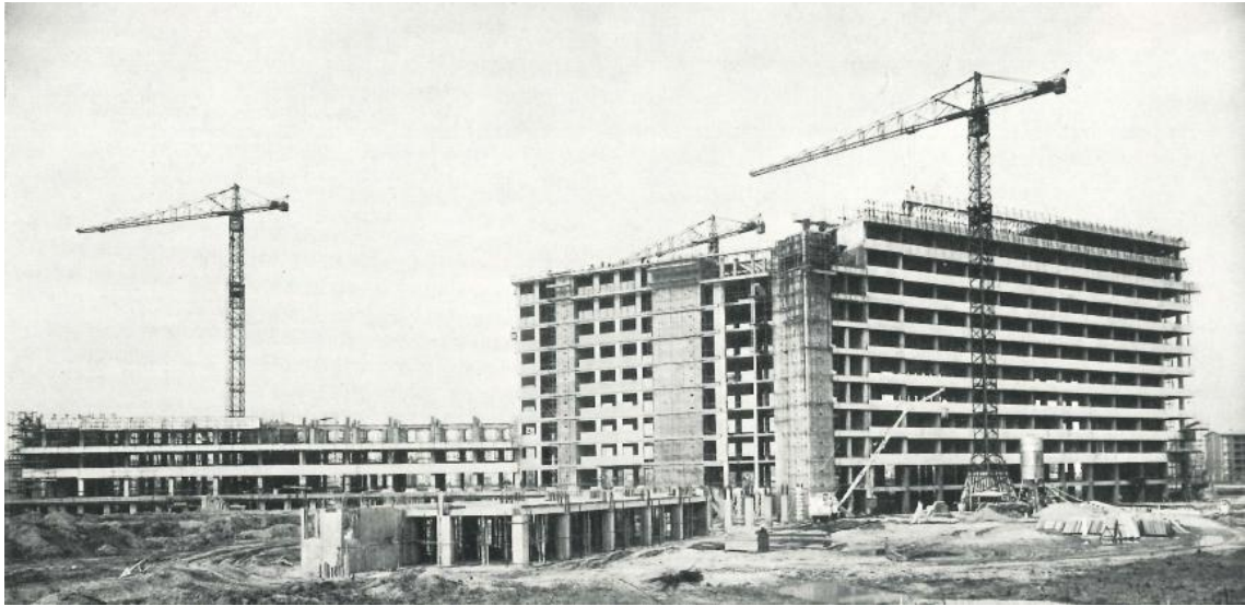
Figura 26 – Cantiere dell'Ospedale San Carlo Borromeo nel 1964 (da Chiappa F., L'Ospedale San Carlo Borromeo)
