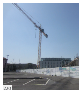
220. Vista del cantiere situato di fronte al parcheggio del Politecnico di Milano di via Raffaele Lambruschini angolo via Privata Stefano Siccoli.
