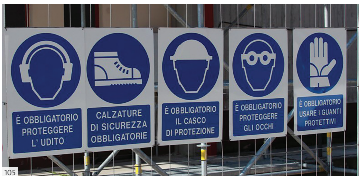
105. Segnali di sicurezza posti in corrispondenza degli accessi al cantiere prescrivono l'obbligo degli indumenti di sicurezza da indossare all'interno del cantiere.
