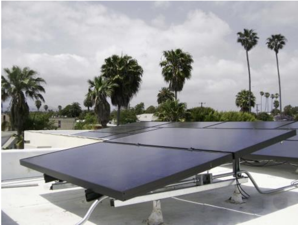
Fig. 52 Array di pannelli fotovoltaici SunPower X21-335
