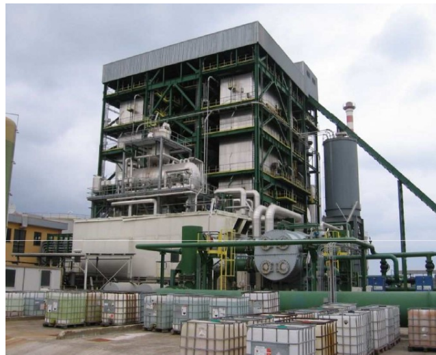
Figura 37. Caldaia con alimentazione a nastro trasportatore. [24]
