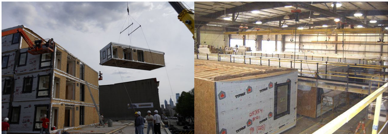
Fig.2.3.20: INTERFACE STUDIO Architects, Modular apartments, Philadelphia, 2010. L'assemblaggio in cantiere dei moduli abitativi costruiti off-site .
