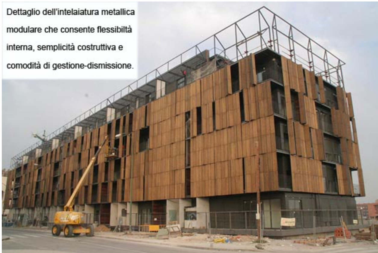
Fig.2.2.18: Carabanchel 16, FOA, Madrid, 2007. Veduta dell'edificio in fase di costruzione. E' visibile la struttura in travi e pilastri di acciaio modulari.
