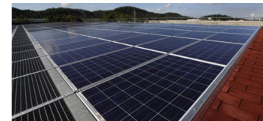
Figura 7.60 Esempio di fotovoltaico su copertura piana
