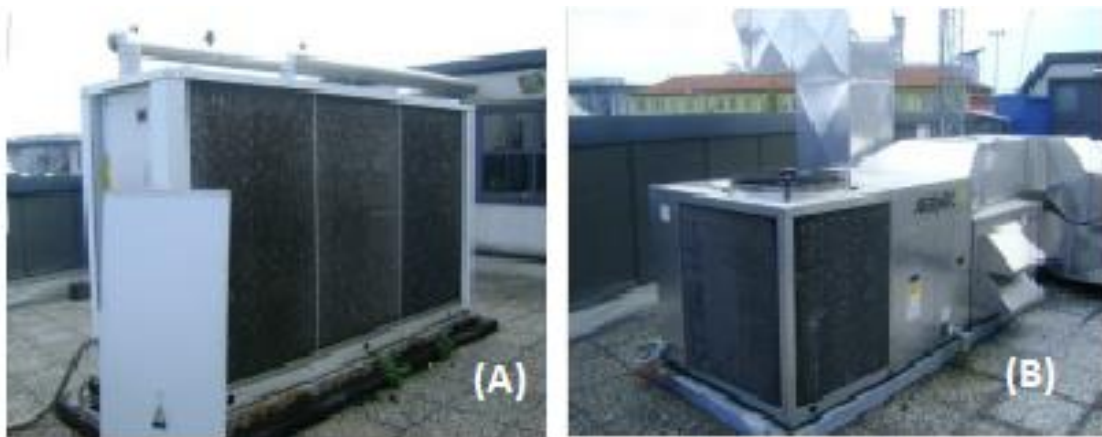
Figura 2.5. Foto delle CF 14. Nell'immagine (A) si ha il gruppo frigorifero condensato ad aria, marca ECOFLAM, mentre nella (B) si ha il gruppo frigorifero di tipo "Roof Top", marca AERMEC
