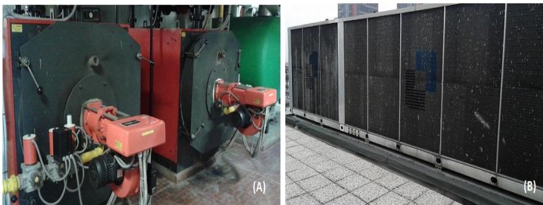
Figura 2.12. Foto delle centrali termica e frigorifera installate sulla copertura dell'edificio 10. Nella (A) si possono vedere le due caldaie BIASI da 854 kW, mentre nella (B) sono presenti i due gruppi frigoriferi CLIMAVENETA da 775 kWf cad.
