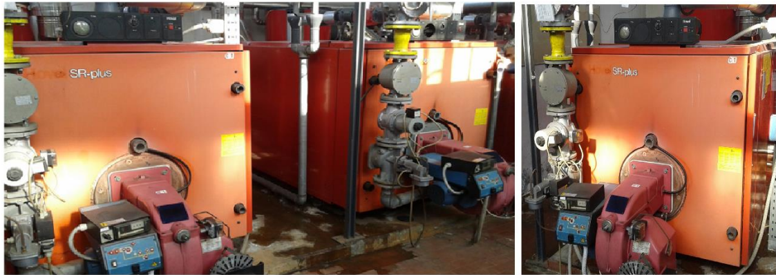
Figura 2.3. Foto delle 3 caldaie marca HOVAL SR PLUS ubicate al piano terra di un locale tecnico nelle vicinanze dell'edificio 13.
