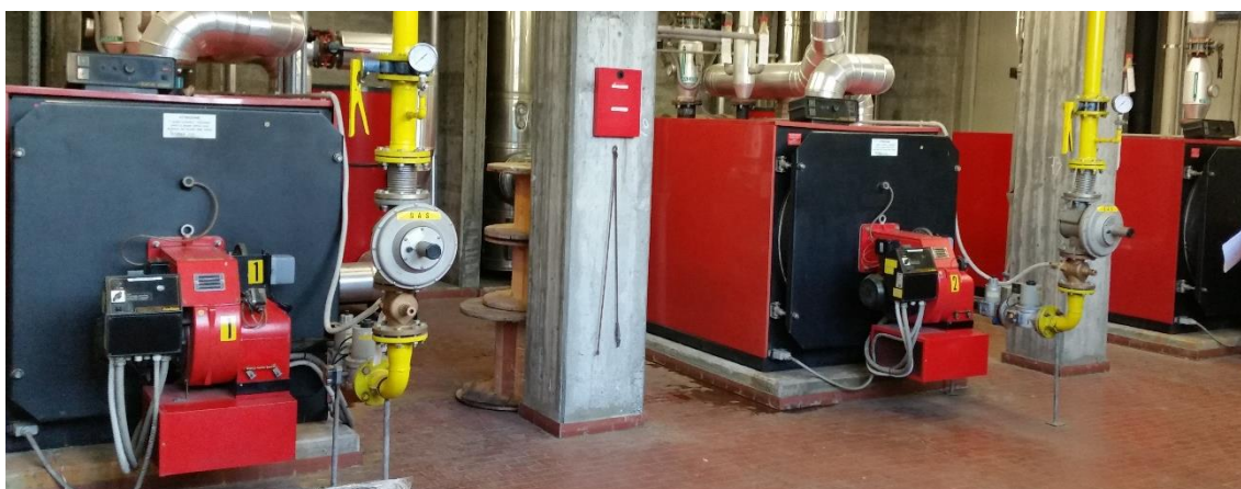
Figura 2.2. Foto delle 3 caldaie ECOFLAM collocate al piano terra dell'edificio Galleria del vento
