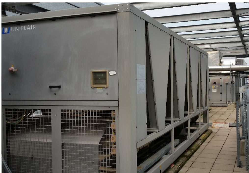
Figura 2.7. Foto dei chiller installati sull'edificio 23, modello Uniflair BRAC da 425 kWf
