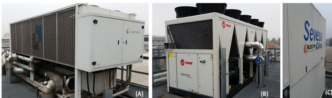
Figura 2.4. Foto dei gruppi frigo della CF4. Nella figura (A) si ha il Climaveneta da 537 kWf, nella (B) il TRANE da 522 kWf., nella (C) il SEVESO da 390 kWf (di questo modello ne sono presenti due a servizio del solo edificio 12)
