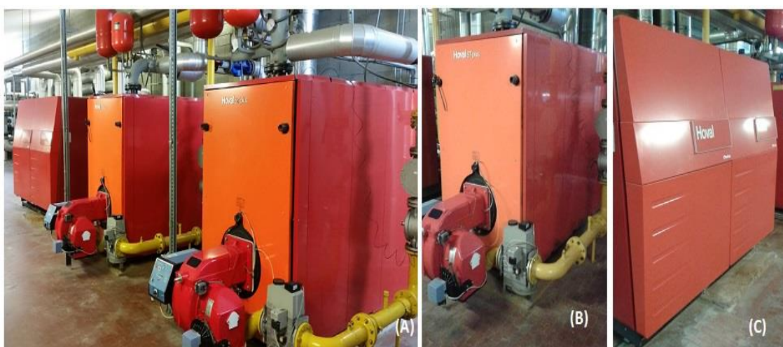
Figura 2.10. Foto delle tre caldaie presenti nella centrale termica ubicata presso l'edificio 8. Nella (A) si vedono tutte le caldaie allineate, mentre nella (B) e nella (C) si ha un dettaglio sulle due tipologie di caldaie presenti. In particolare nella (B) si può vedere la Hoval da 1514 kW, invece nella (C) la Hoval Ultragas a condensazione da 2x667 kW.
