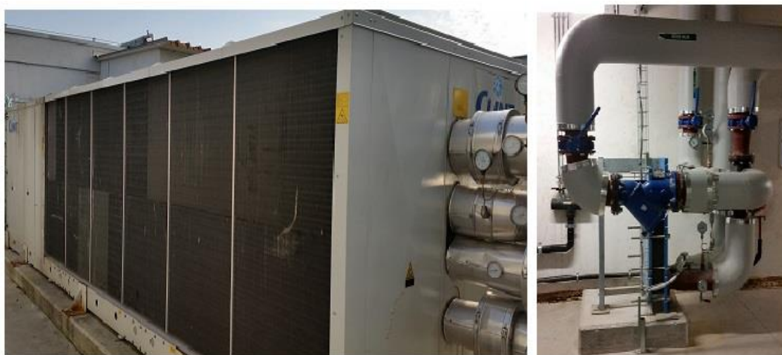
Figura 2.6. Foto della pompa di calore reversibile Clint, e dell'heat exchanger presente nell'edificio 18, che scambia calore con l'acqua calda proveniente dalla CT 6, ubicata nell'edificio 19.
