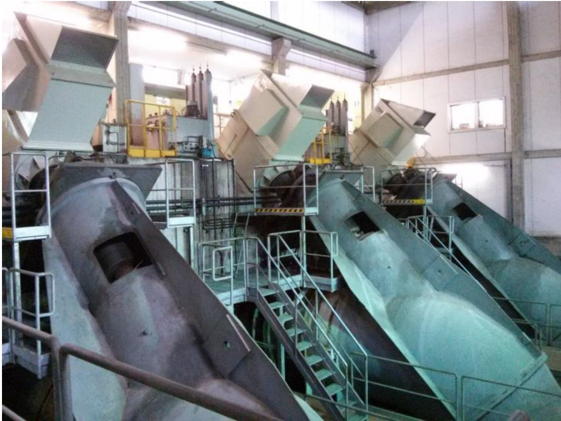
Figura 4.3 Vista dall'interno della centrale
