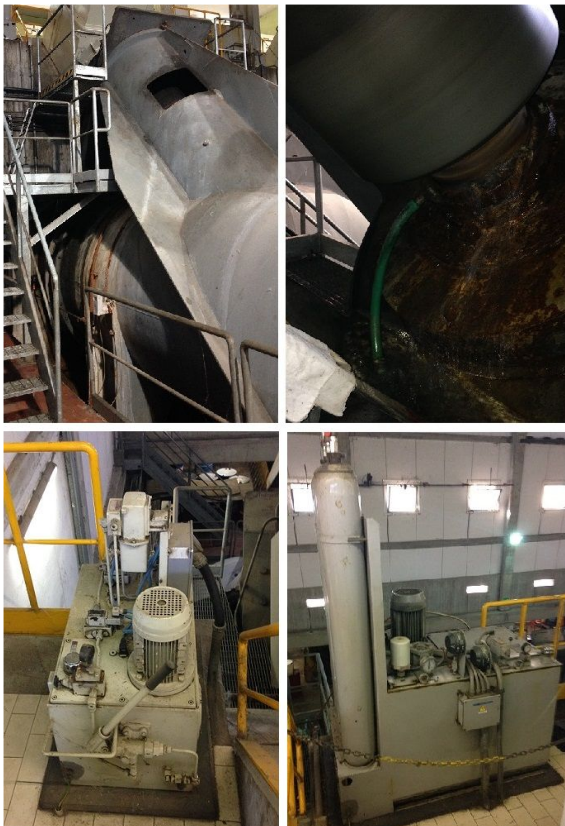
Figura 6.1 Stato attuale della turbina e relativi accessori
