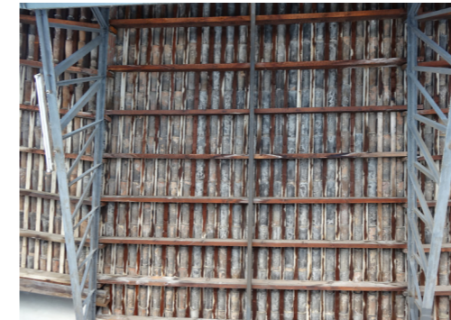
Vista della struttura del tetto scarsamente controventata
