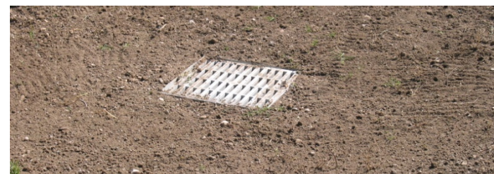
Figura 160: particolare del pozzetto di raccolta acqua meteorica
