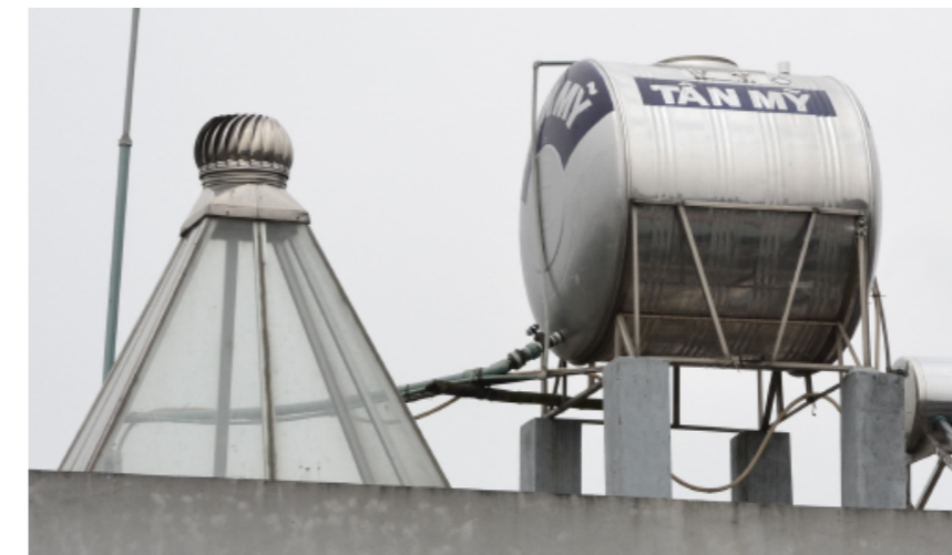
Figura 5.17 Piramide di estrazione dell’aria e boiler
