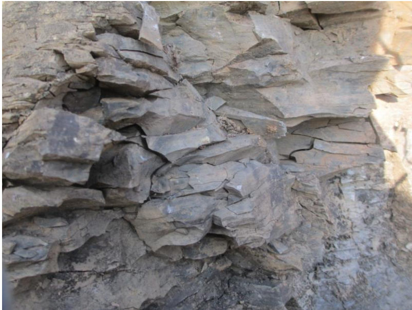
Figura 32: Evidenza di distacco di blocchi all'interno della formazione del Calcarea di Zu
