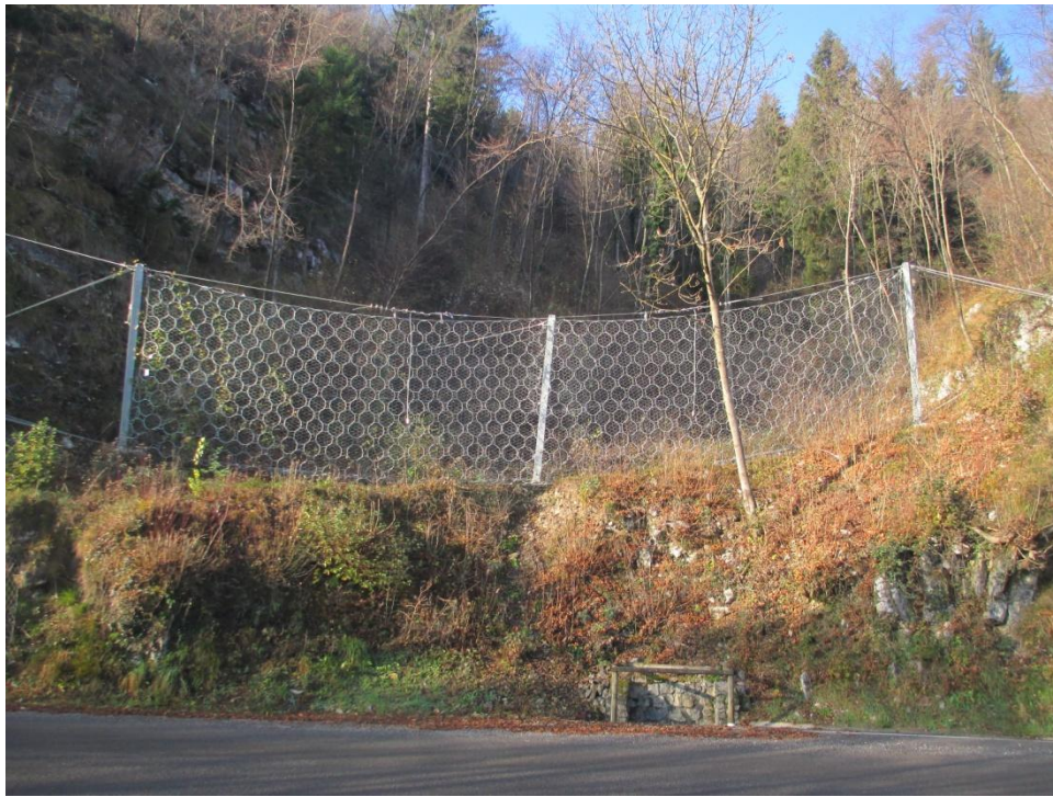
Figura 23: Rete paramassi finalizzata alla protezione della strada che collega Bondo a Colzate
