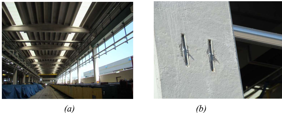
Figura 2.12 Crollo del rivestimento durante il terremoto dell'Aquila; (a) vista della linea di pannelli orizzontali crollati, (b) particolare dei fissaggi che hanno ceduto
