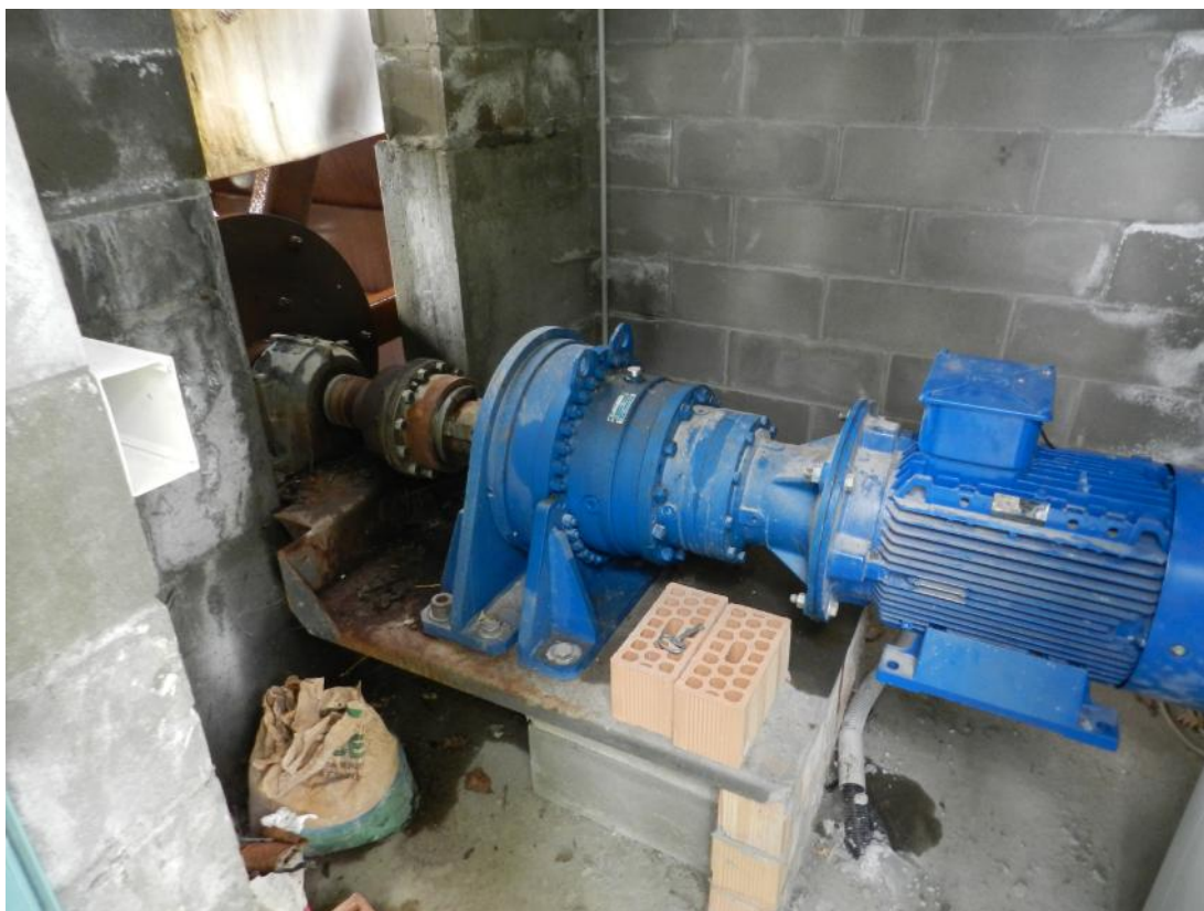
Figura 20: interno della centralina, generatore
