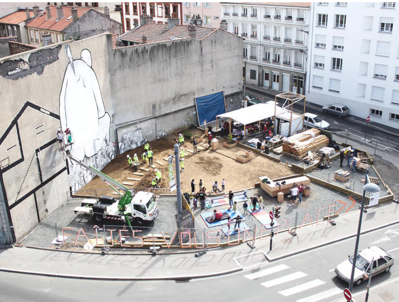
Fig. 2.59 Sulla parete, si possono osservare la sezione del futuro condominio e il murales degli artisti Ella&Pitr <<
