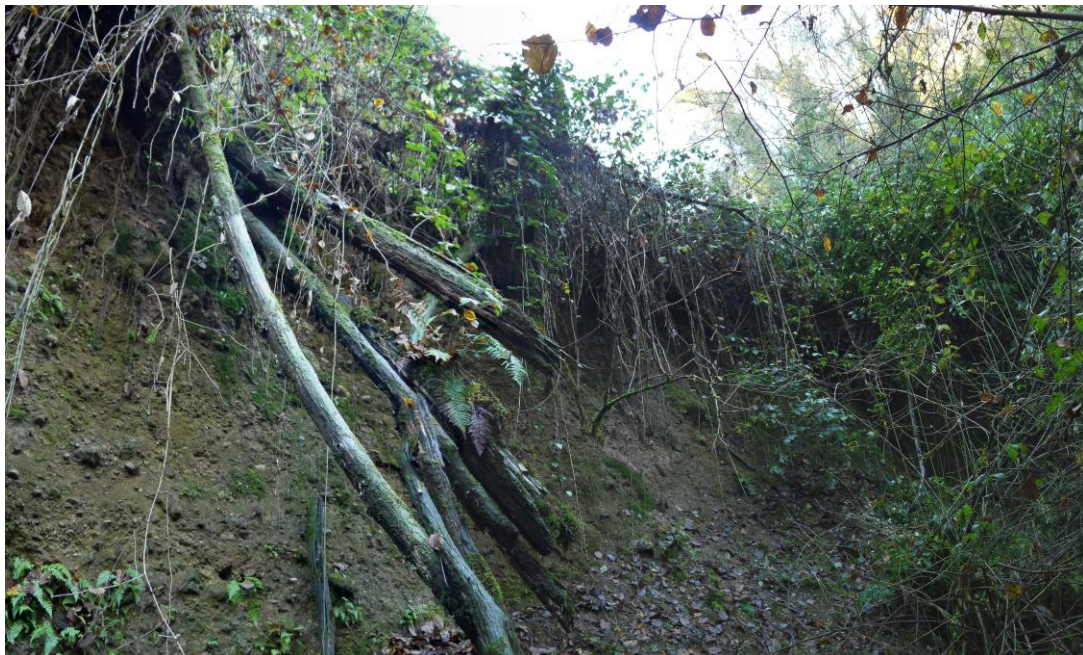
Figura 20 - Nicchia di frana con fenomeni di erosione (roggia Vallone) (Barozzi et al., 2015)
