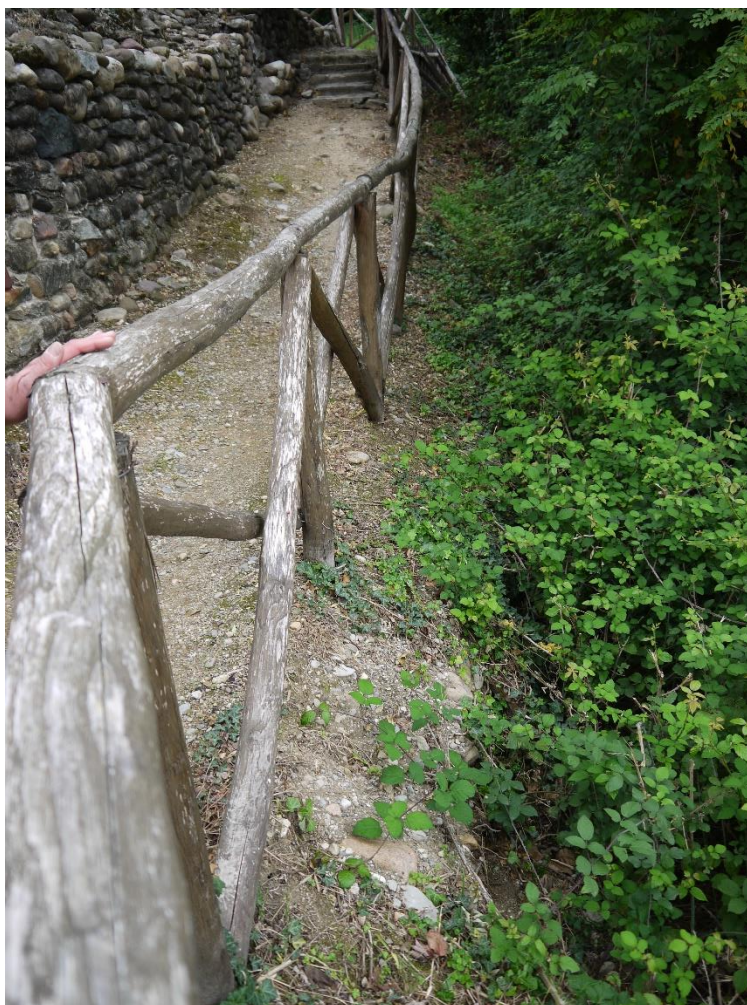
Figura 22 - Evidenze di cedimenti lungo il perimetro del Parco Archeologico (Barozzi et al., 2015)
