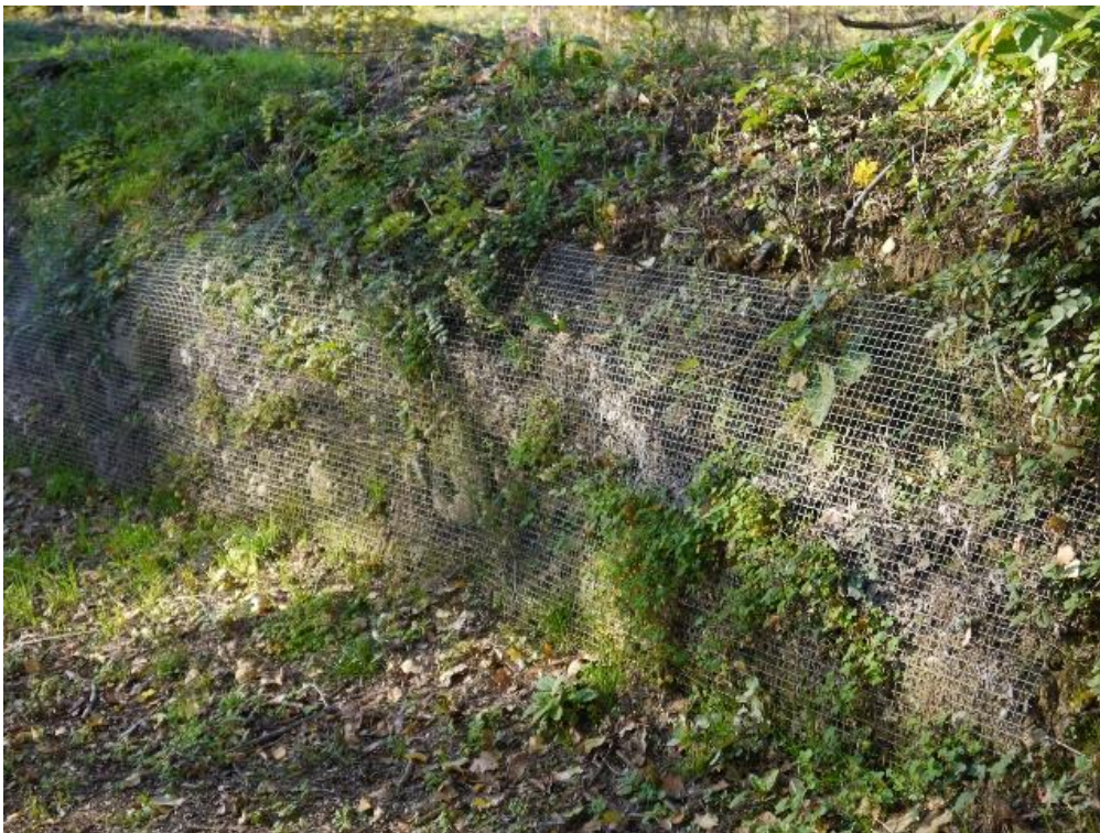
Figura 27 - Rete metallica parzialmente ricoperta dalla vegetazione posizionata lungo il margine meridionale del terrazzo (Barozzi et al., 2015)
