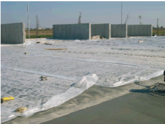
fig.9.71 TELI IN POLIETILENE DOPO LA FASE DI GETTO I teli vengono sistemati coprendo la parte esposta di cls
