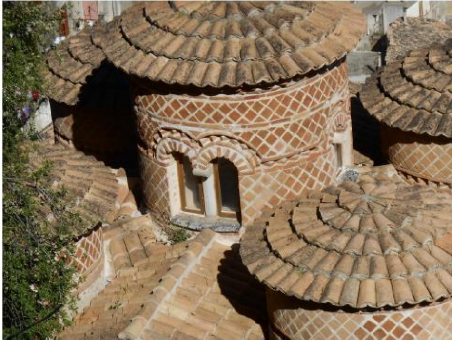
Figura 43-Dettagli della copertura: presenza di arbusti e depositi
