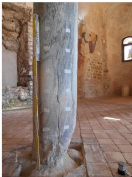
Figura 51-Dettaglio alla base della colonna C2S con fessurazione verticale e sezione ridotta
