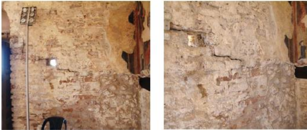
Figura 46-Dettaglio della fessurazione presente sul lato interno del muro sud
