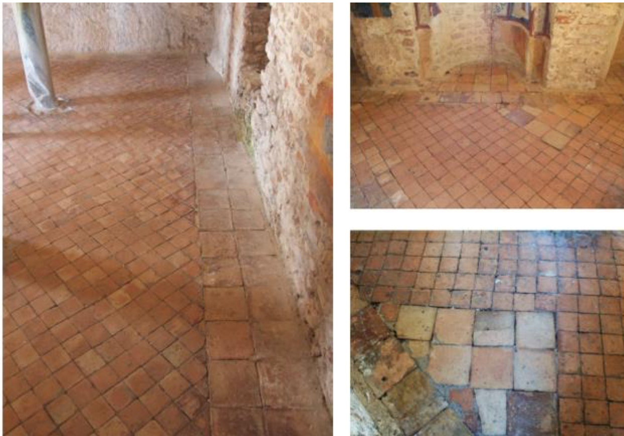
Figura 41- Vista della pavimentazione e dettaglio della pavimentazione riparata in prossimità dell'abside centrale
