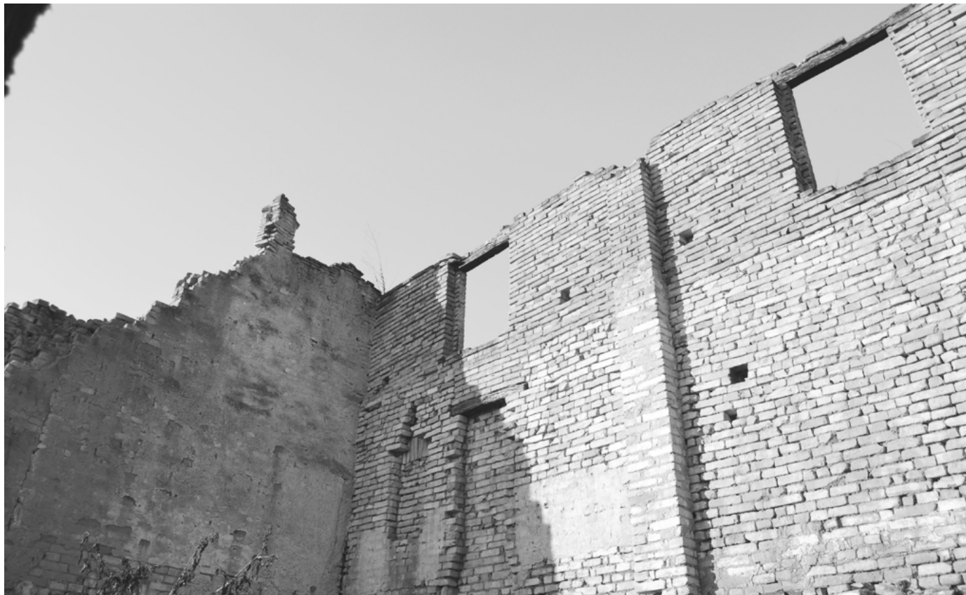
Dettaglio del tetto mancante
