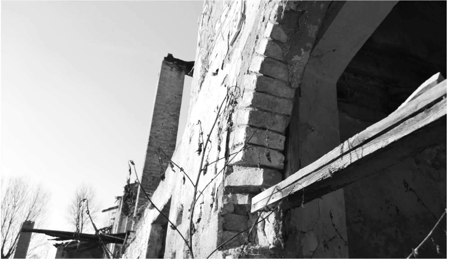
Dettaglio sullo stato di abbandono
