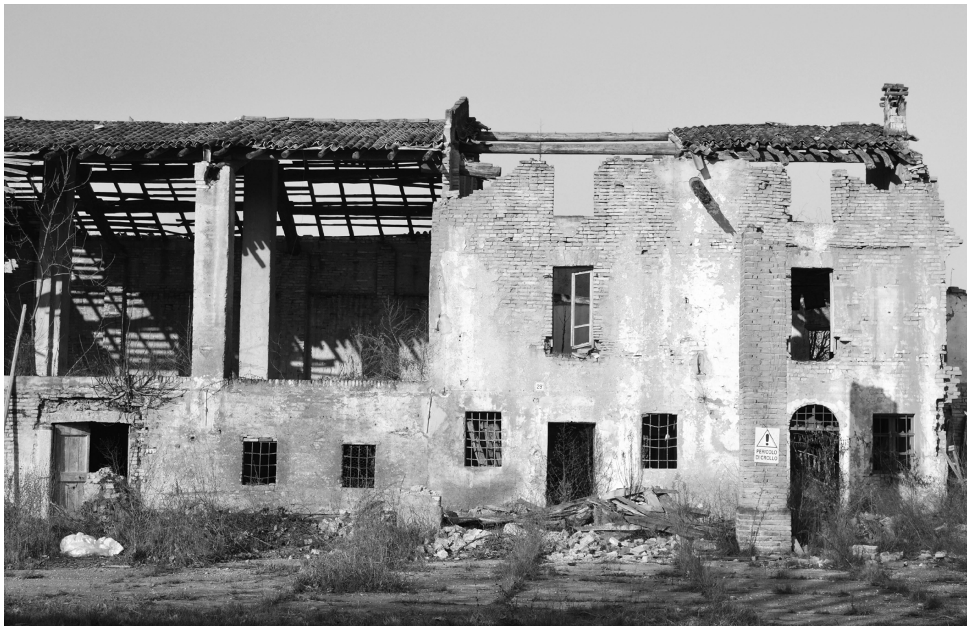
Dettaglio sullo stato di abbandono, lato sud
