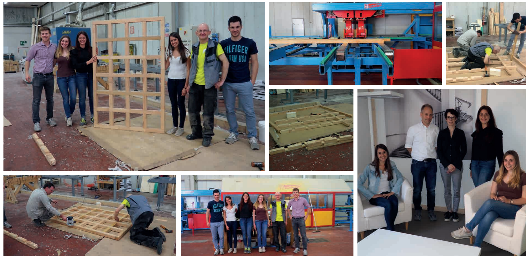
Figura 535_Taglio degli elementi verticali e orizzontali del prototipo a graticcio presso il centro di taglio dell'azienda Ri-Legno a Cavedine (Trento)
