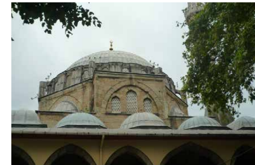
Fig. 7.38 Prospetto Nord-Ovest; patologia in atto: deposito superficiale; alterazione cromatica.
