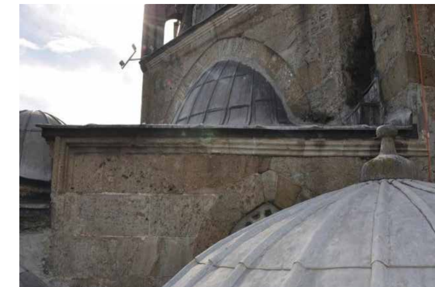
Fig. 7.36 Prospetto Nord-Ovest; patologia in atto: Erosione
