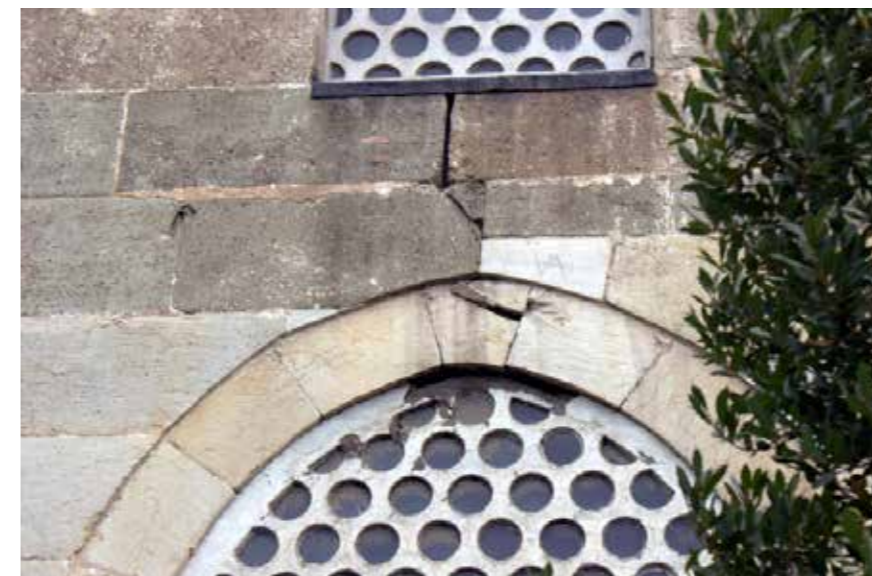
Fig. 7.35 Prospetto Sud-Est; fessura strutturale
