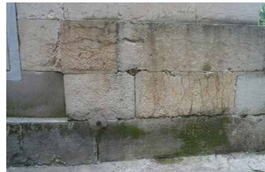
Fig. 7.37 Prospetto Nord-Ovest; patologia in atto: presenza di muschi e licheni
