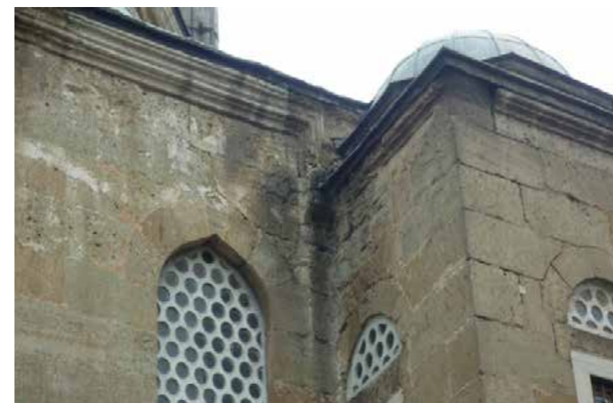
Fig. 7.33 Prosp. Nord-Ovest; patologie in atto: efflorescenza salina e alterazione cromatica
