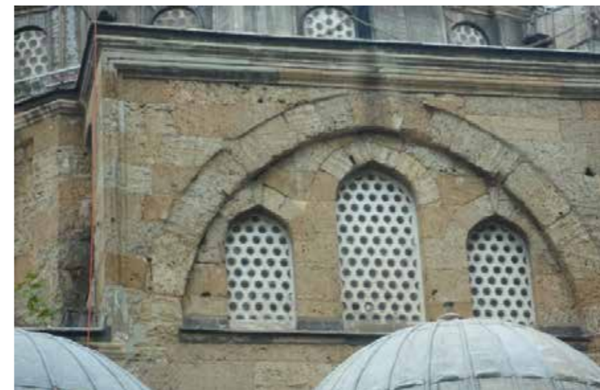
Fig. 7.32 Prosp. Nord-Est; patologie in atto: alveolizzazione; dilavamento; alterazione cromatica.
