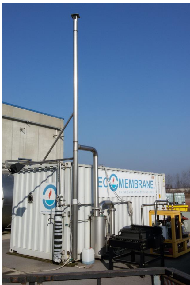
Figura 15: Sezione di accumulo/scarico del biogas prodotto dall'impianto pilota. Il container bianco è il gasometro dell'impianto, il condotto verticale è la torcia mentre nella struttura metallica gialla è situato il motore per lo sfruttamento del biogas.
