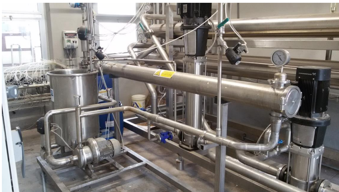
Figura 7: Membrana di ultrafiltrazione per la separazione delle sieroproteine. I moduli filtranti sono alloggiati nel cilindro metallico posto in orizzontale, il siero entra dal condotto di diametro inferiore che si inserisce dal basso nella parte destra e i flussi prodotti (permeato e concentrato) fuoriescono all'estremità di sinistra della struttura.
