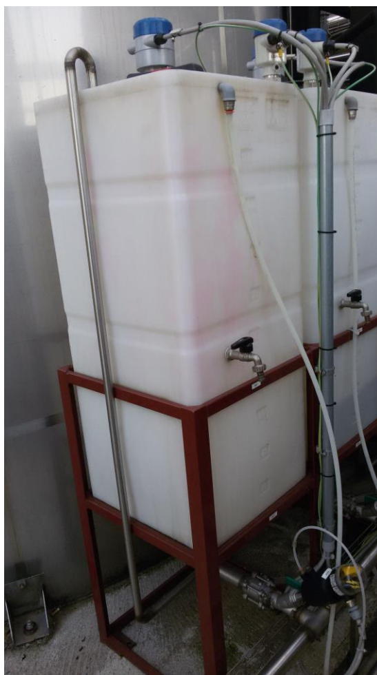
Figura 14: Serbatoio di accumulo dei fanghi attivi spurgati dal digestore (B07).
