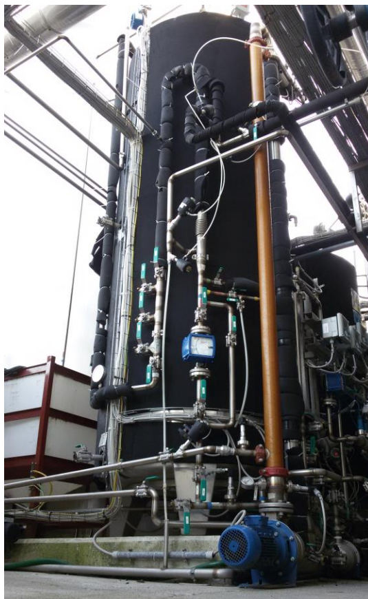
Figura 11: Digestore anaerobico dell'impianto pilota (Bo3). La parte nera è una coibentazione aggiunta a posteriori ed il cilindro arancio è la membrana di ultrafiltrazione. In basso, in blu, la pompa del ricircolo.
