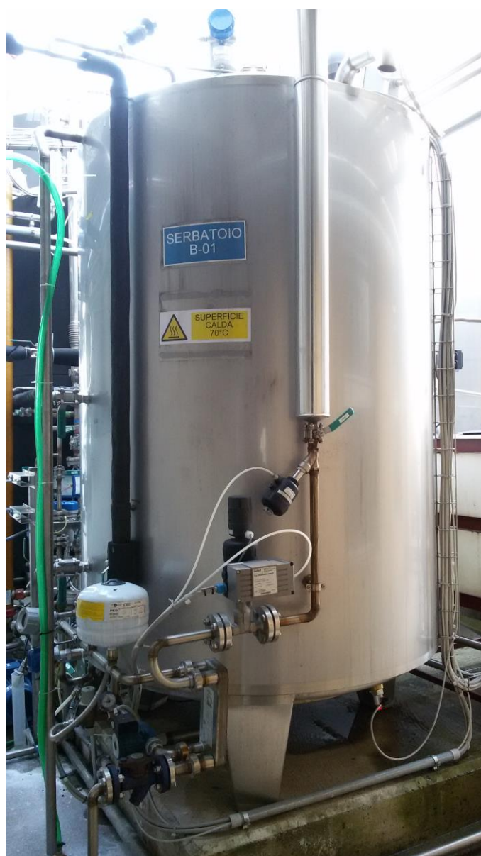
Figura 9: Serbatoio di accumulo dell'impianto pilota (B01).
