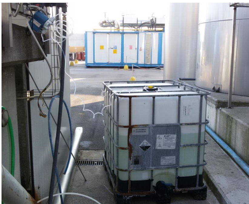
Figura 12: Sezione di dosaggio della soda caustica. In alto a sinistra la pompa dosatrice a stantuffo, a destra il cubo di stoccaggio da cui viene prelevata la soluzione.
