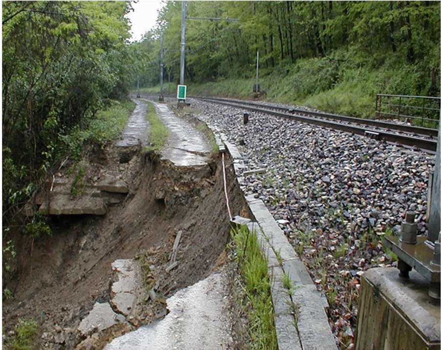
Figura 1.1-C Frana vista verso laveno
