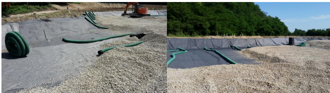
Figura 4.10: riempimento del bacino 1 con visibili le tubazioni di drenaggio e il primo strato di riempimento
