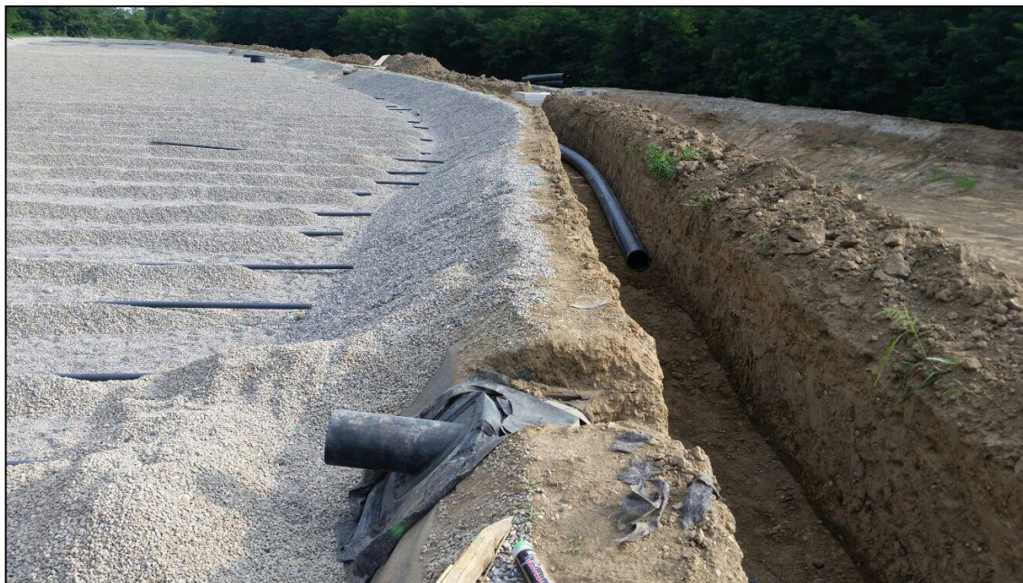
Figura 4.19: passatelo per la congiunzione delle tubature in profondità con le tubazioni esterne
