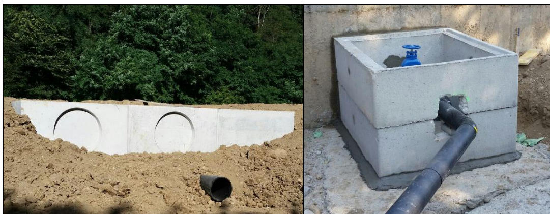
Figura 4.14: opere in cemento prefabbricato con passamuro
