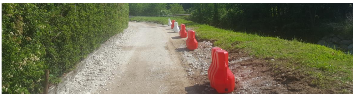
Figura 4.4: segnalazioni dei sottoservizi per evitare problematiche legate al passaggio dei mezzi
