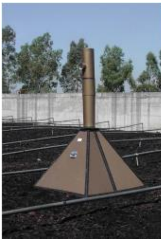
Figura 1: cappa statica posta su biofiltro
