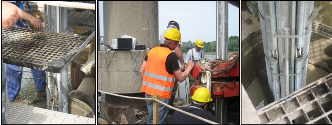
Figura 3.7: Foto riguardanti l'installazione di BLESS.
