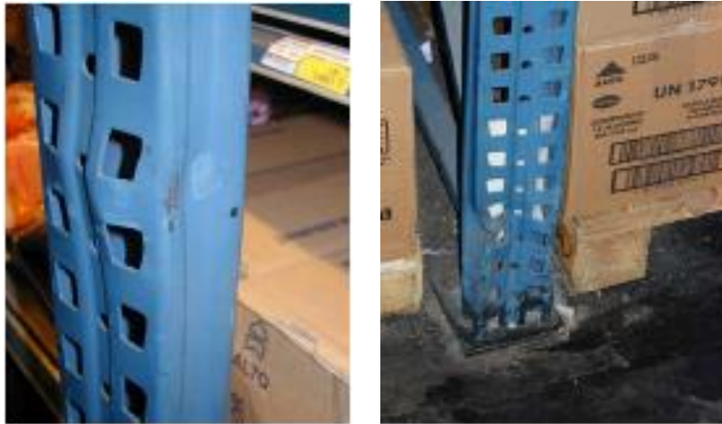
Figura 1.12: Esempi di danno strutturale
