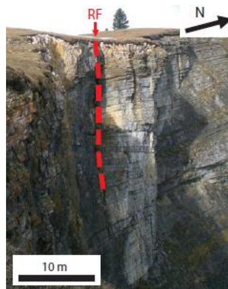
Figura 2.10 Colonna instabile di Les Arches
