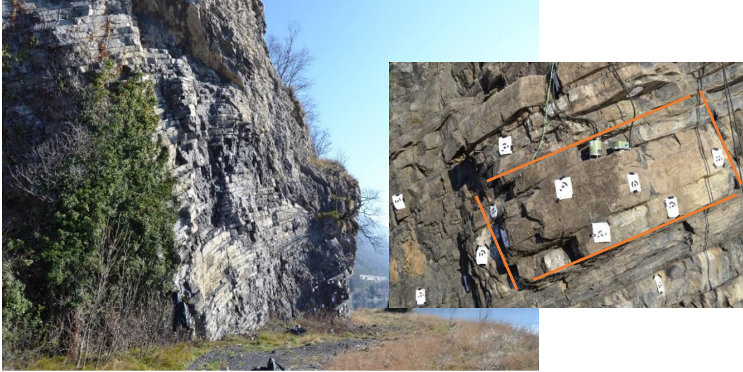
Figura 4.4 Foto panoramica della zona dove si può notare la stratificazione della roccia (a sinistra); masso instabile considerato (a destra)
