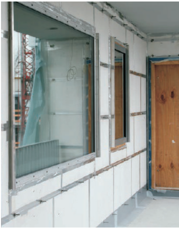
Foto 2.3 VIP - Un vantaggio significativo è rappresentato dagli spessori ridotti, necessari per creare un prodotto sottovuoto. Ciò si combina ai possibili svariati utilizzi. Nella foto, un esempio di applicazione: l'isolamento di una parete perimetrale. Fonte: Ditta tedesca Porextherm.
