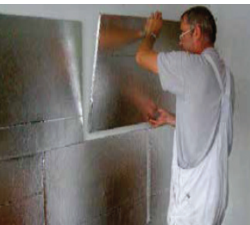
Foto 2.8 VIP - L'operaio installa i pannelli in una partizione verticale interna. Ditta Befire.
