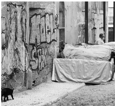
Fig. 130_Umidità di risalita sulle pareti prossime all'ingresso del Jardim Botânico
