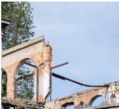
Fig. 132_Degrado avanzato delle strutture metalliche di appoggio che collegano una facciata con l'altra
