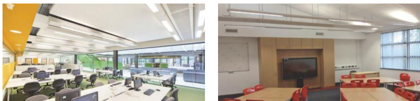
Fig. 8.17 Newcastle College, Trox Technik, aula con uso di travi fredde attive; Rykneld School, aula con sistema ibrido dato da pannelli radianti e sistemi a miscela
