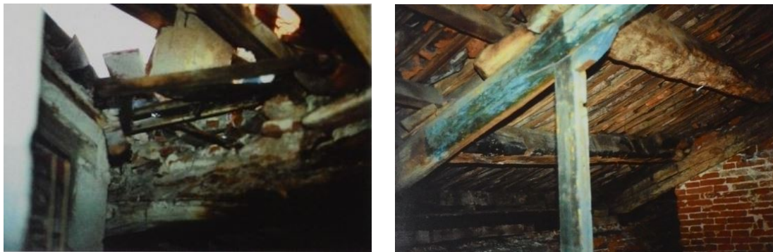
Figura 101 - Degrado della copertura di Casa Bossi prima dell'intervento
