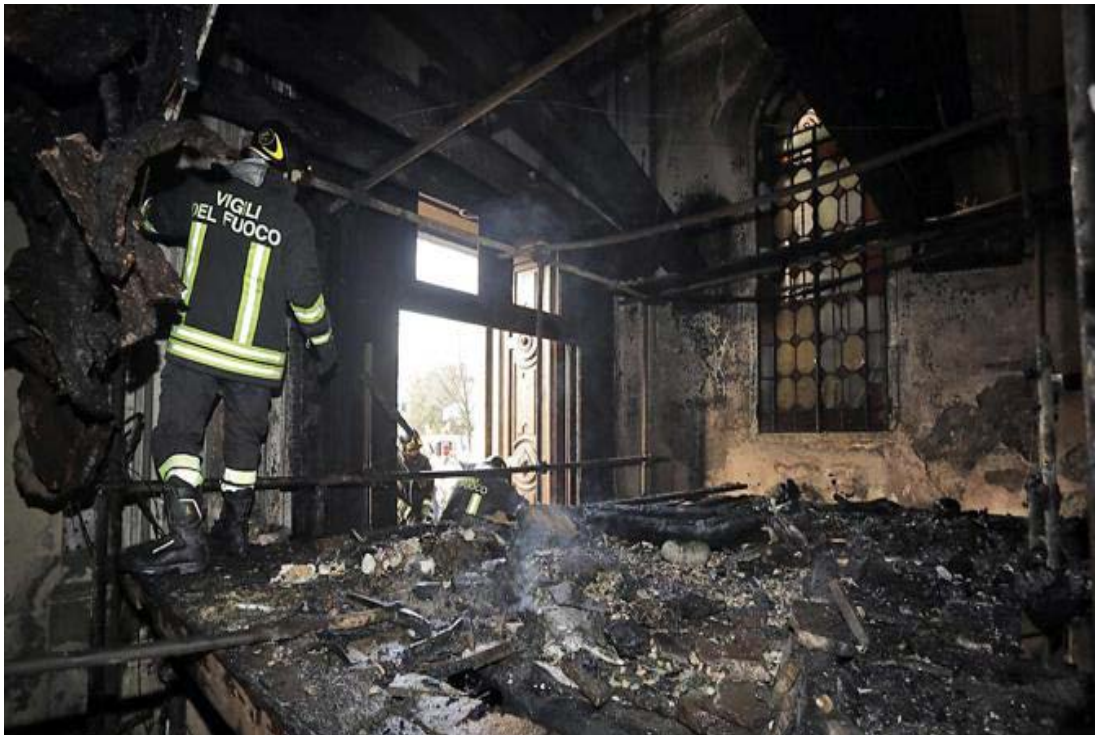
Figura 57 - Conseguenze dell'incendio nella chiesa di Fontaniva (PD), 2015
