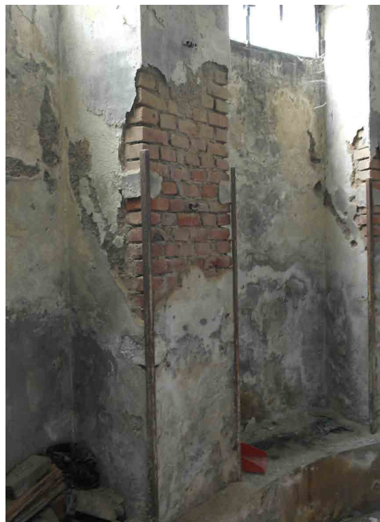
Fig. 44 Vista del degrado materico in una delle esedre del piano semi interrato
