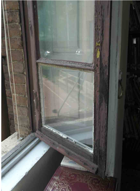
Fig. 45 Vista del degrado materico degli infissi nella biblioteca dei ragazzi
