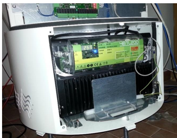
Figura 7.5 Batteria FZSoNick installata all'interno del sistema Zhero
