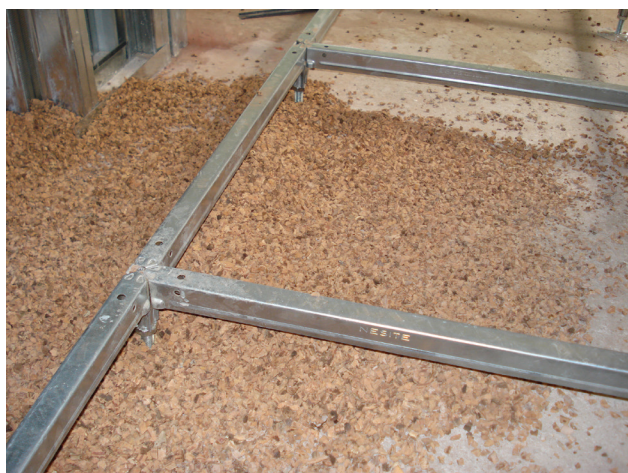
Figura 10.20: L'isolamento dei pavimenti è realizzato con sughero riciclato; Fonte: http://www.savnoservizi.it/ ;
