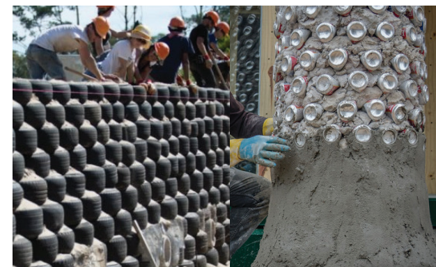
Figura 10.54: Realizzazione della struttura portante con pneumatici e realizzazione delle colonne in lattine di alluminio rivestite; Fonte: https://www.plataformaarquitectura.cl/ ;
