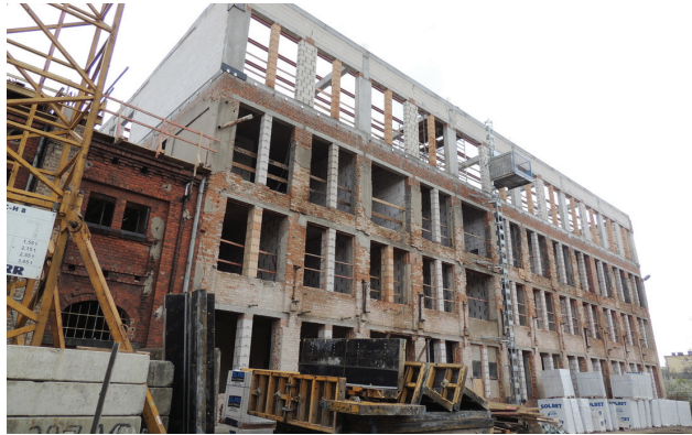
Figura 10.145: L'edificio esistente sottoposto a recupero con sopraelevazione di un nuovo piano; Fonte: http://www.nanowoarchitekci.pl/ ;
