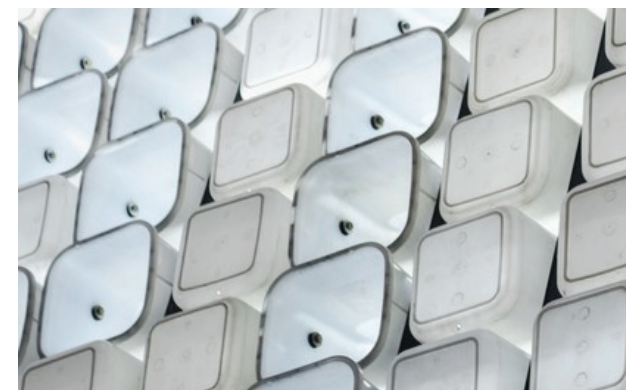
Figura 10.39: Le vaschette di recupero sono imbullonate a una struttura metallica garantendo la possibilità di rimuoverle selettivamente; Fonte: https://www.archdaily.com/ ;
