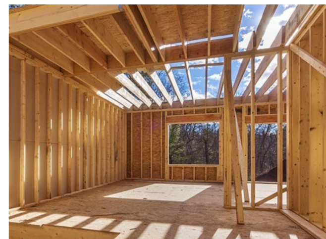
Fig. 5.4.6 Foto di un esempio di casa con struttura portante prefabbricata a telaio
