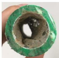
Figura 3.19 - Foto dell’interno di una tubazione del loop al termine della prima prova di sporcamento
