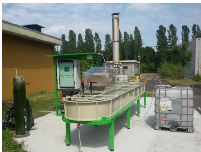
Figura 3.1: Raceway presente all’interno del depuratore di Bresso-Niguarda (MI)
