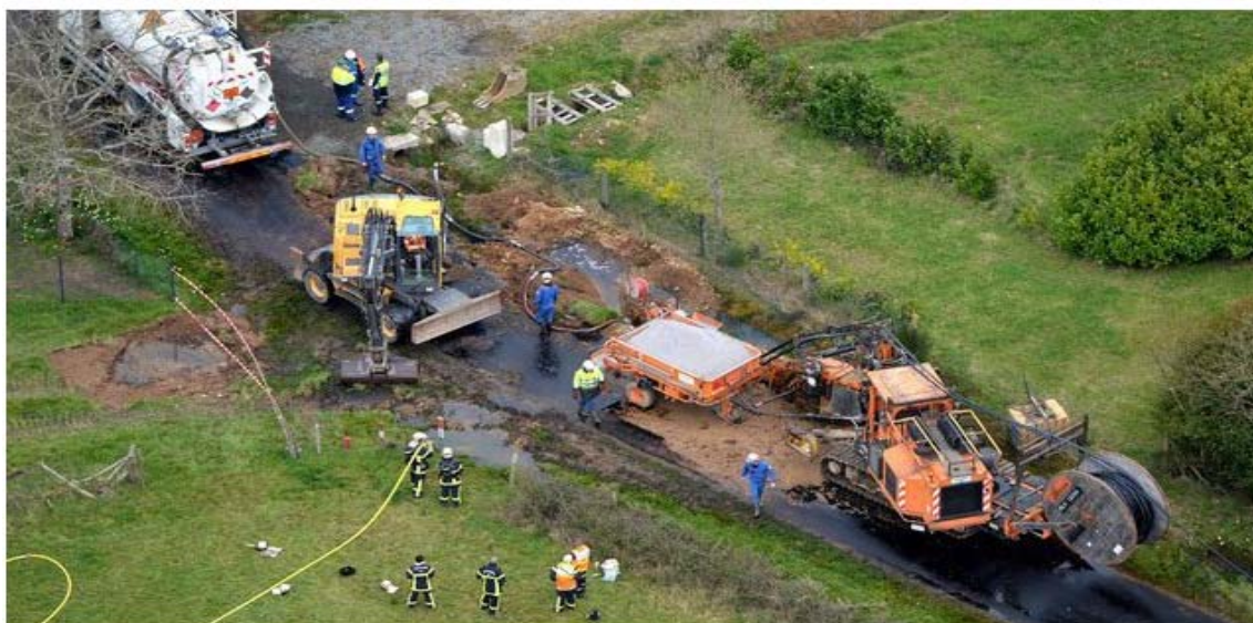
Figura 20 Rottura di un oleodotto sotterraneo avvenuto in Francia nel 2016
