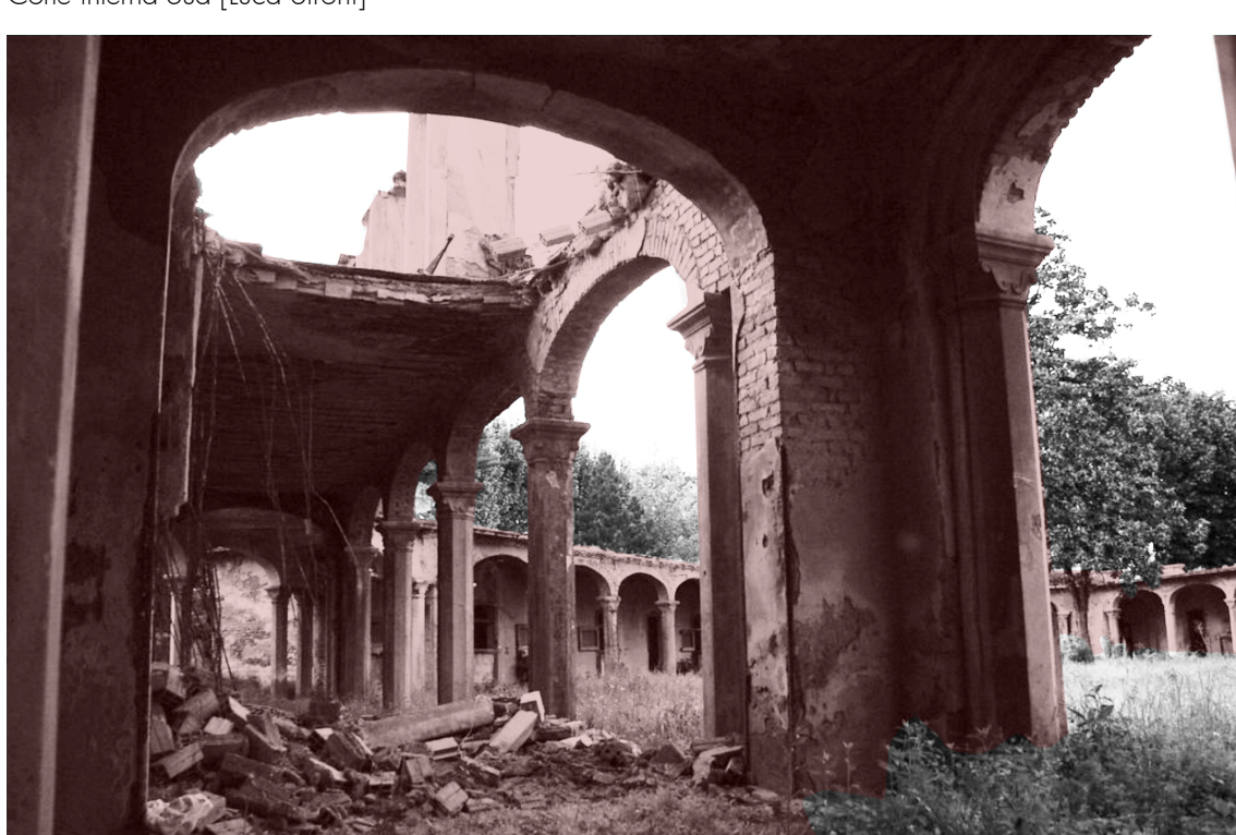
Cedimenti Strutturali, [Luca Sironi]
